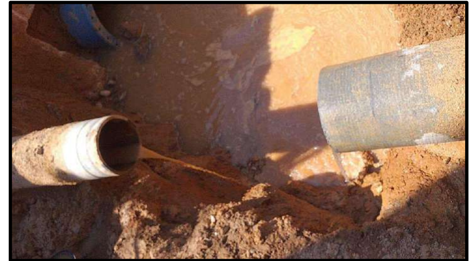
Fotografía nº 3. Corte tubería afectada FC250 suministro a Guadassuar. Detalle 2
