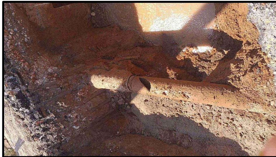
Fotografía nº 1. Tubería afectada FC250 suministro a Guadassuar. Detalle 1
