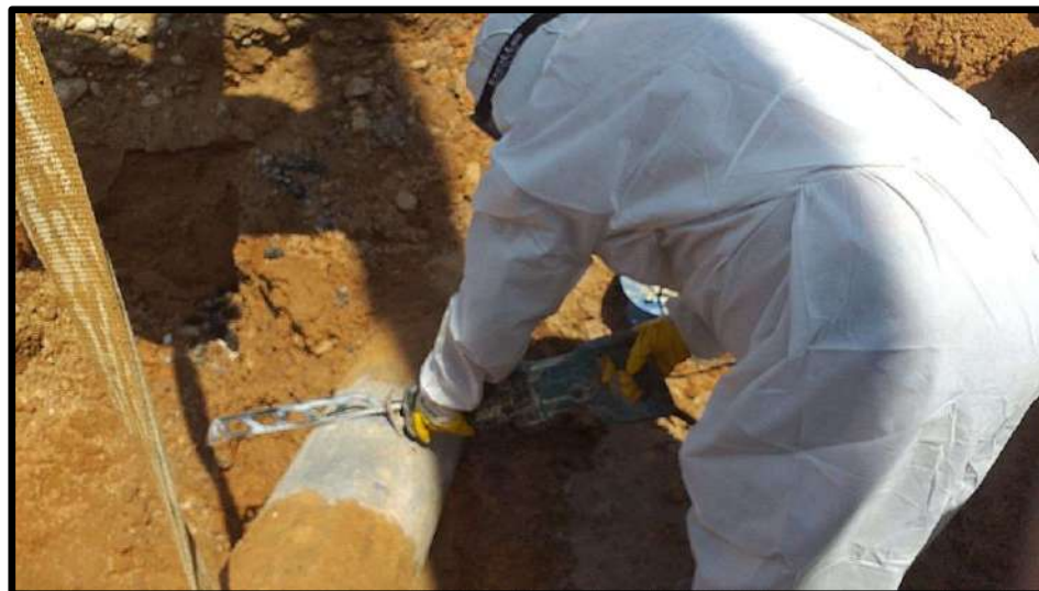
Fotografía nº 2. Corte tubería afectada FC250 suministro a Guadassuar. Detalle 1
