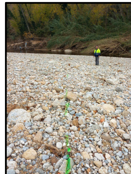
Fotografía 3. Localización aproximada punto de rotura conducción FCØ300
