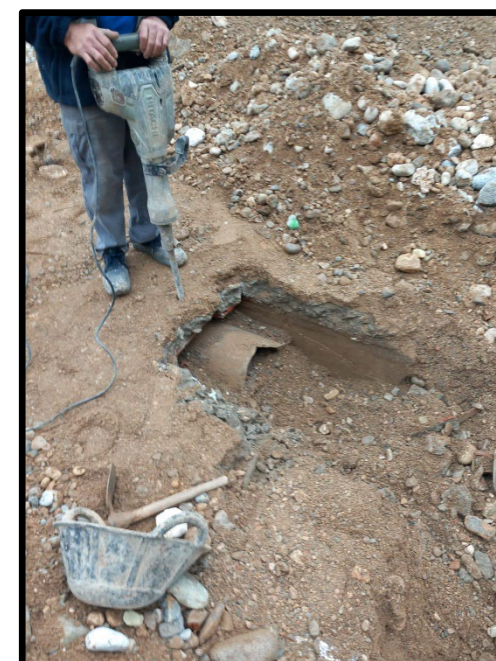
Fotografía 4. Localización aproximada punto de rotura conducción FCØ300
