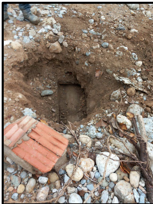
Fotografía 5. Localización aproximada punto de rotura conducción FCØ300
