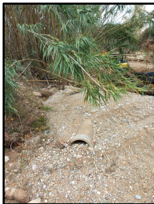
Fotografía 2. Localización aproximada punto de rotura conducción FCØ300
