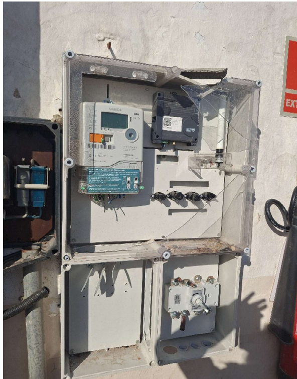
11.- El cableado ha sido usurpado
