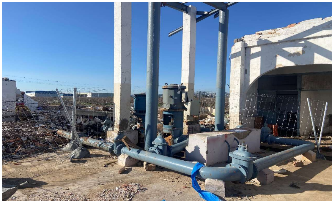
13.- Estado del bombeo a fecha 04 de febrero 2025
