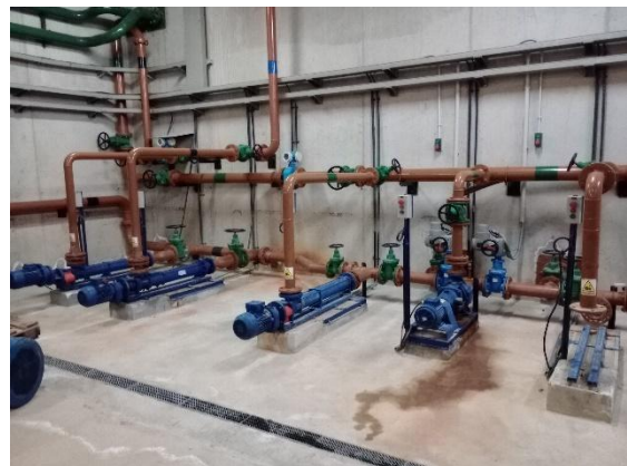
Estado actual de las bombas de purga del fango mixto y digestión. Fuente: Visita (23-01-2025).
