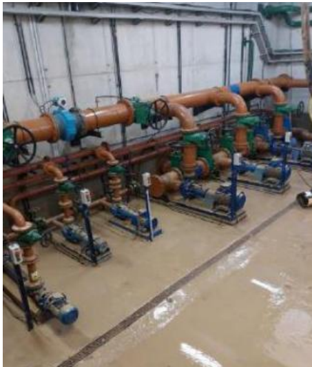
Estado de las bombas de purga y recirculación tras la DANA. Fuente: informe EPSAR.
