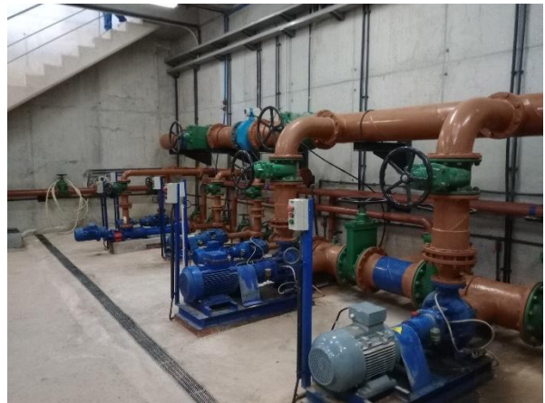
Estado actual de las bombas de purga y recirculación. Fuente: Visita (23-01-2025).
