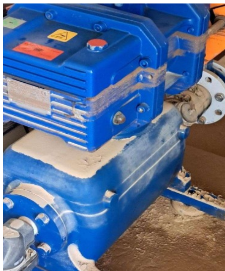
5.-Estado de la bomba después de estar sumergida
