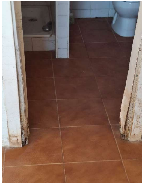
11.-Estado de los marcos y las puertas
