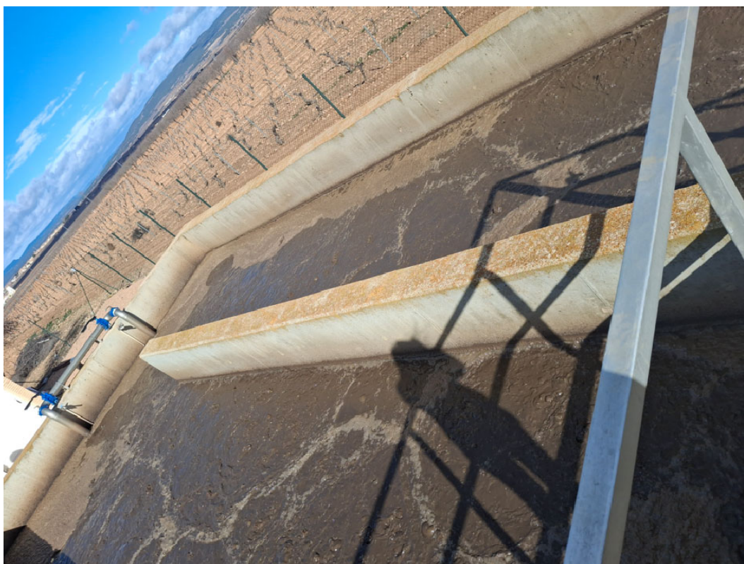
Vista general del reactor biológico de la EDAR. Fuente: Inspección de campo realizada por AMBLING con fecha de 28/01/2025
