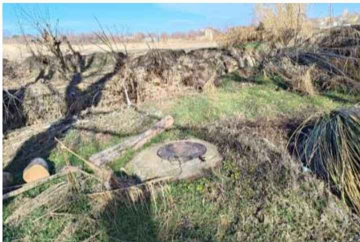
Imagen 1: Pozo del colector a la EDAR de Fuenterrobles
