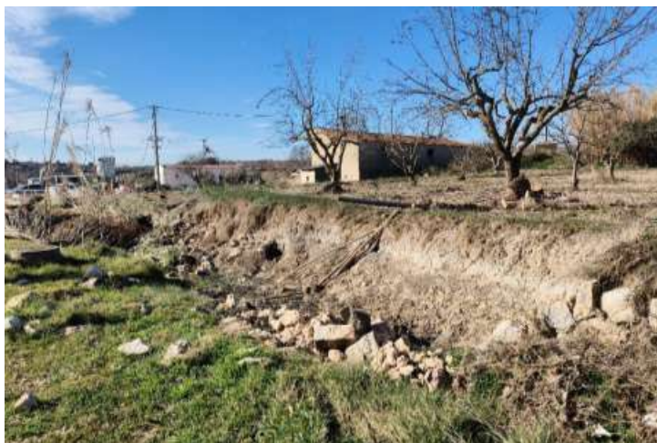
Imagen 3: Acequia aliviadero de pluviales
