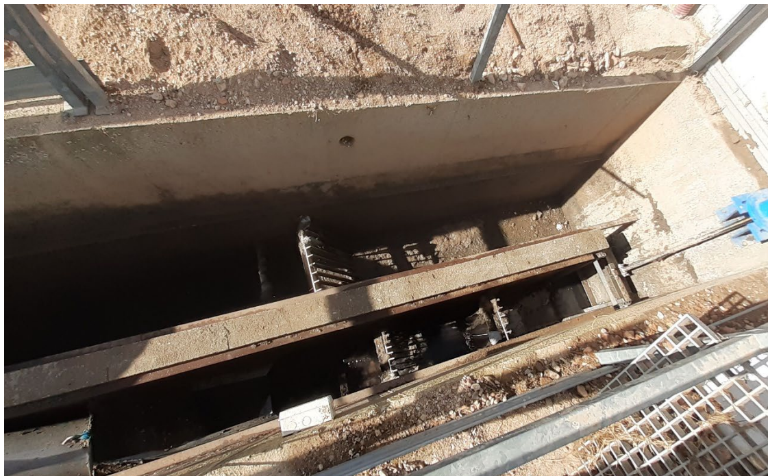
Imagen 8: Desbaste EDAR Fuenterrobles. Fase 0
