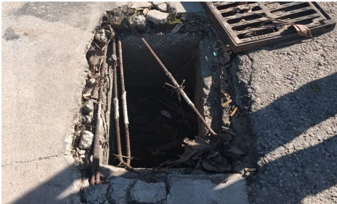
Detalle de sumidero destrozado en el polígono industrial de L'Alcúdia
