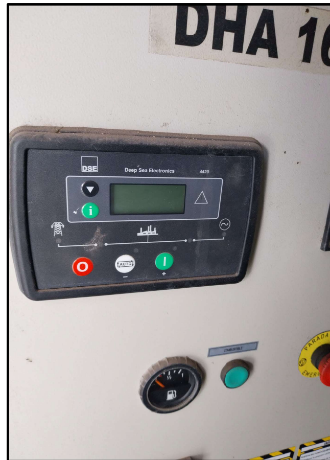
Fotografía nº 4. Cuadro eléctrico del grupo electrógeno
