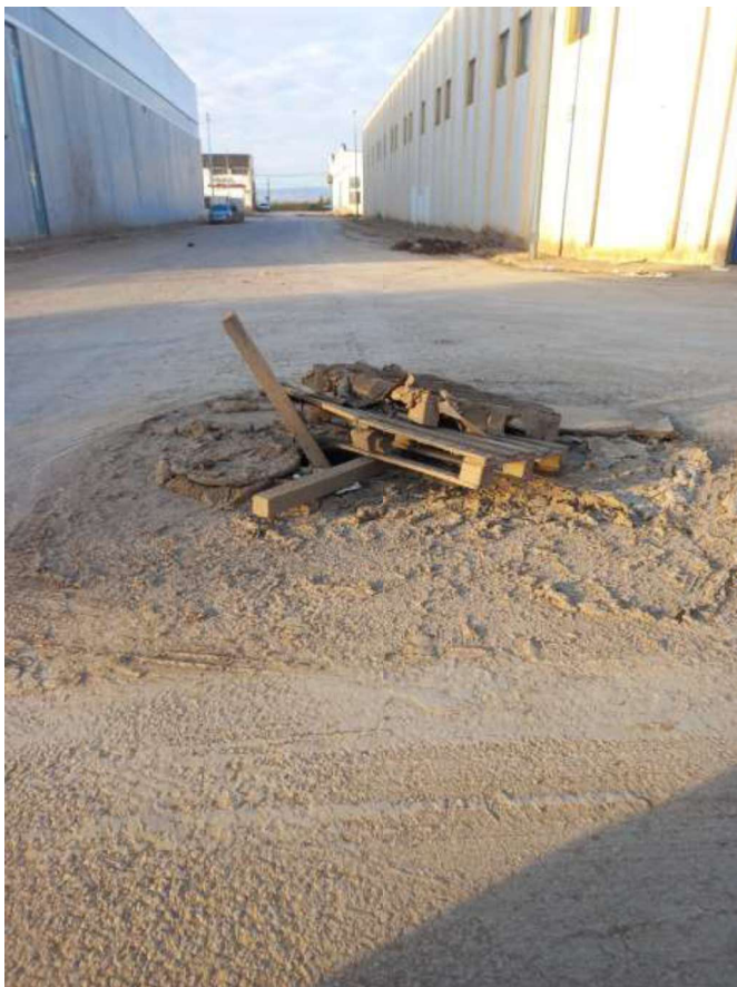
Pozo de registro obturado por barro y escombros
