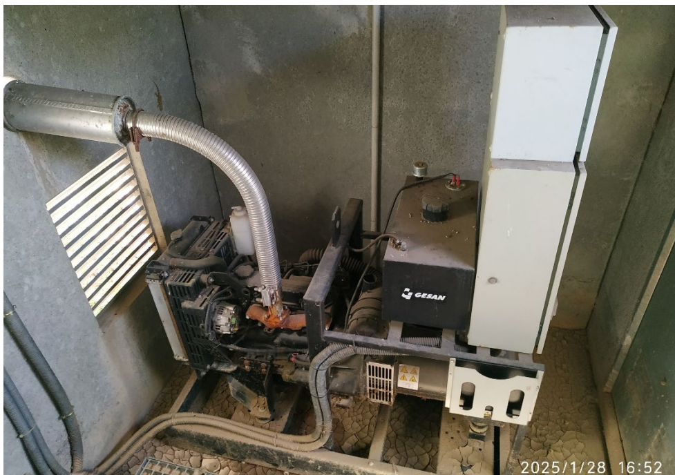
Grupo electrógeno del bombeo
