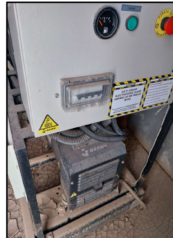
Fotografía nº 2. Estado grupo electrógeno
