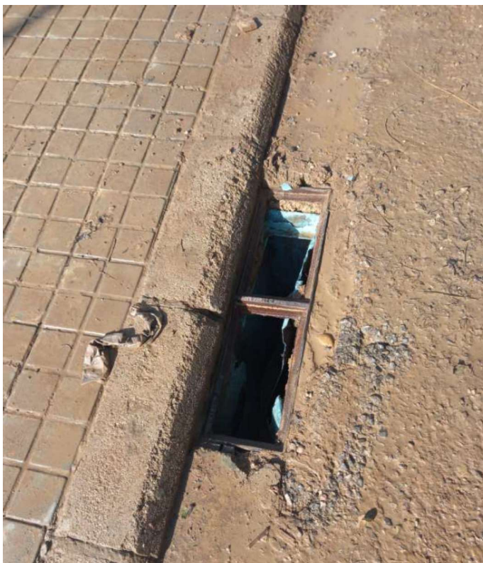
Ilustración 1. Ejemplo de imbornal dañado y sin rejilla e L'Alcúdia.
