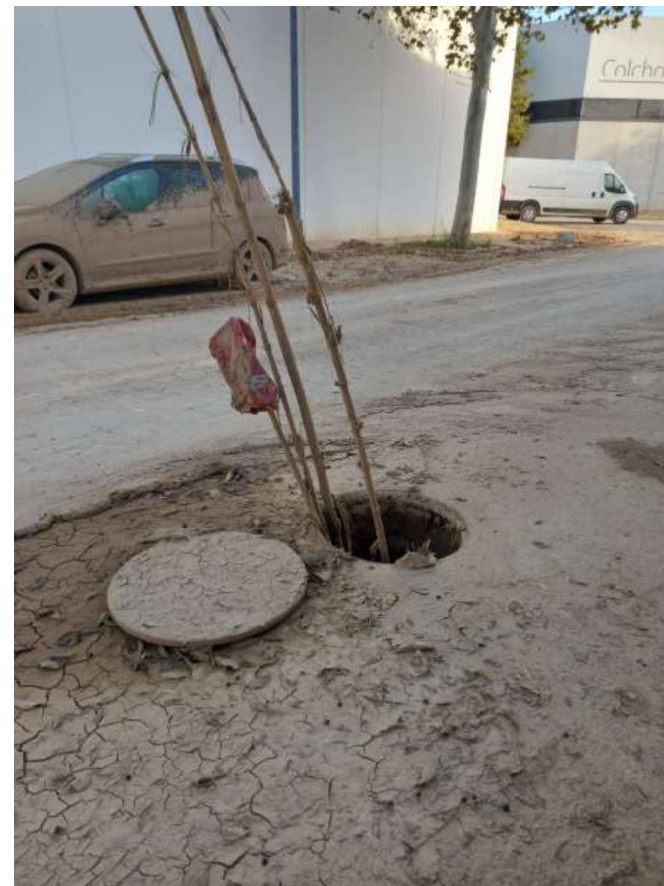
Pozo de registro obturado por barro y ramas arrastradas
