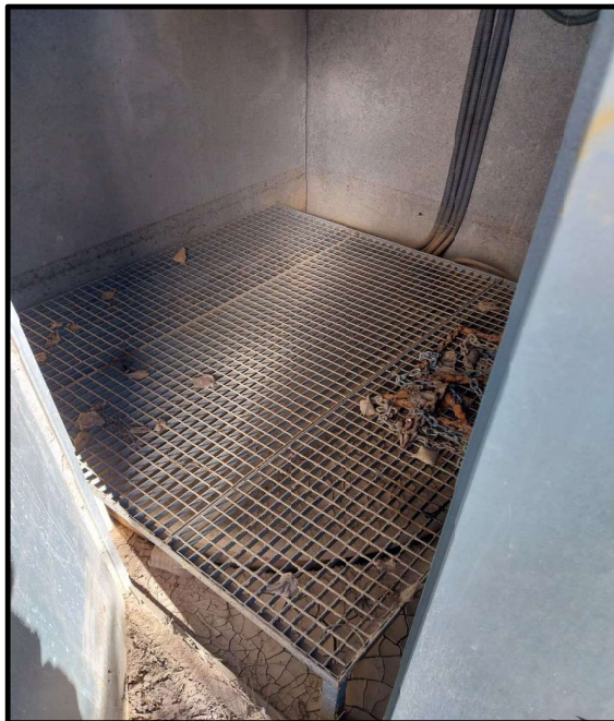
Fotografía nº 1. Caseta del grupo electrógeno
