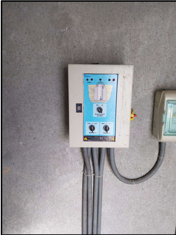
Fotografía nº 5. Cuadro de bombas
