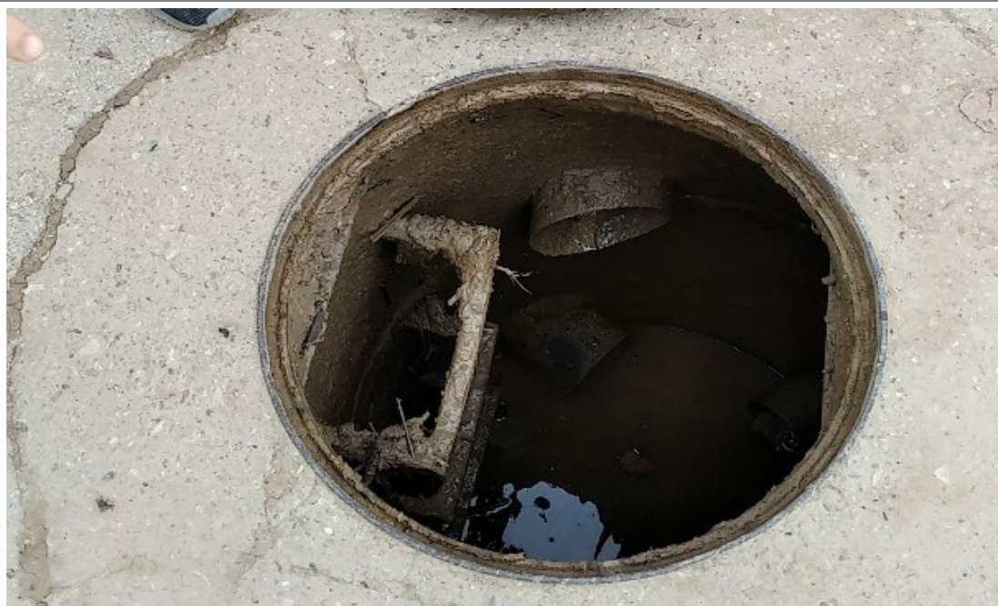
Pozo revisado en la C/ Fco. Tomás y Valiente, a pesar de las limpiezas realizadas el agua apenas circula, lo que denota colmatación en la línea.
