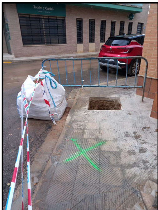
Fotografía nº 1. Fuga en la red.
