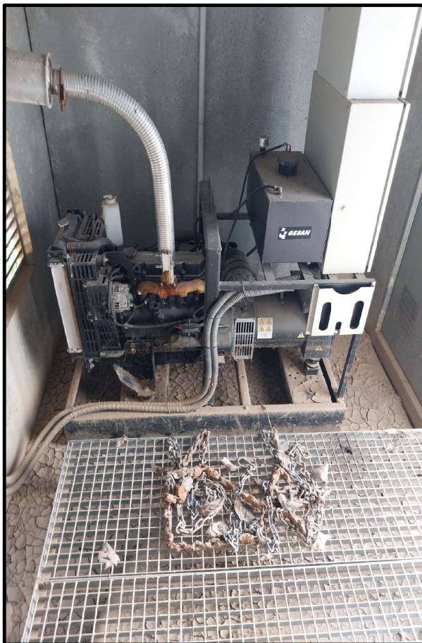
Fotografía nº 3. Estado grupo electrógeno
