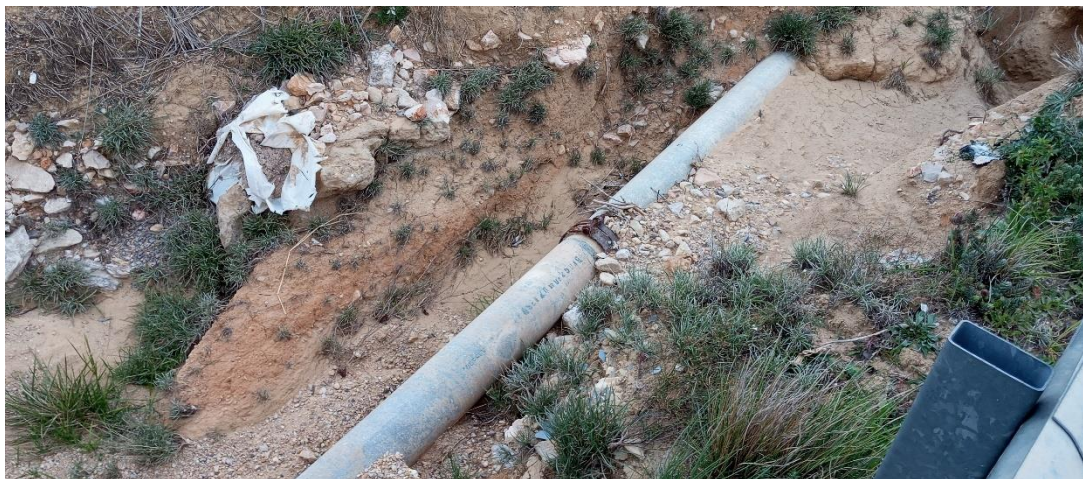
Imagen 2: Estado tubería FC 250 mm principal a Macastre
