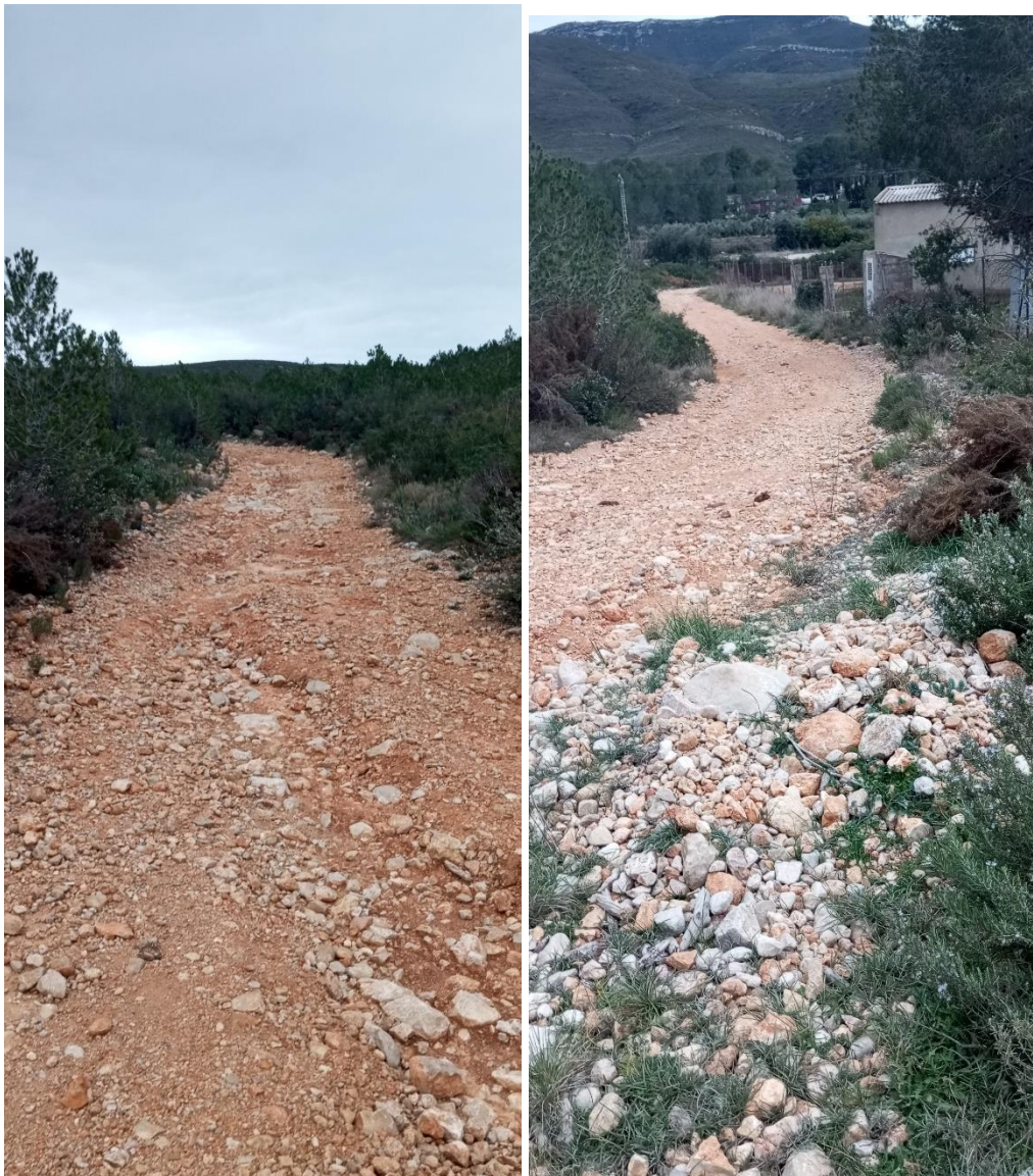
Imagen 8: Estado accesos depósito
