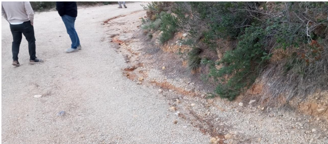
Imagen 5: Estado accesos depósito
