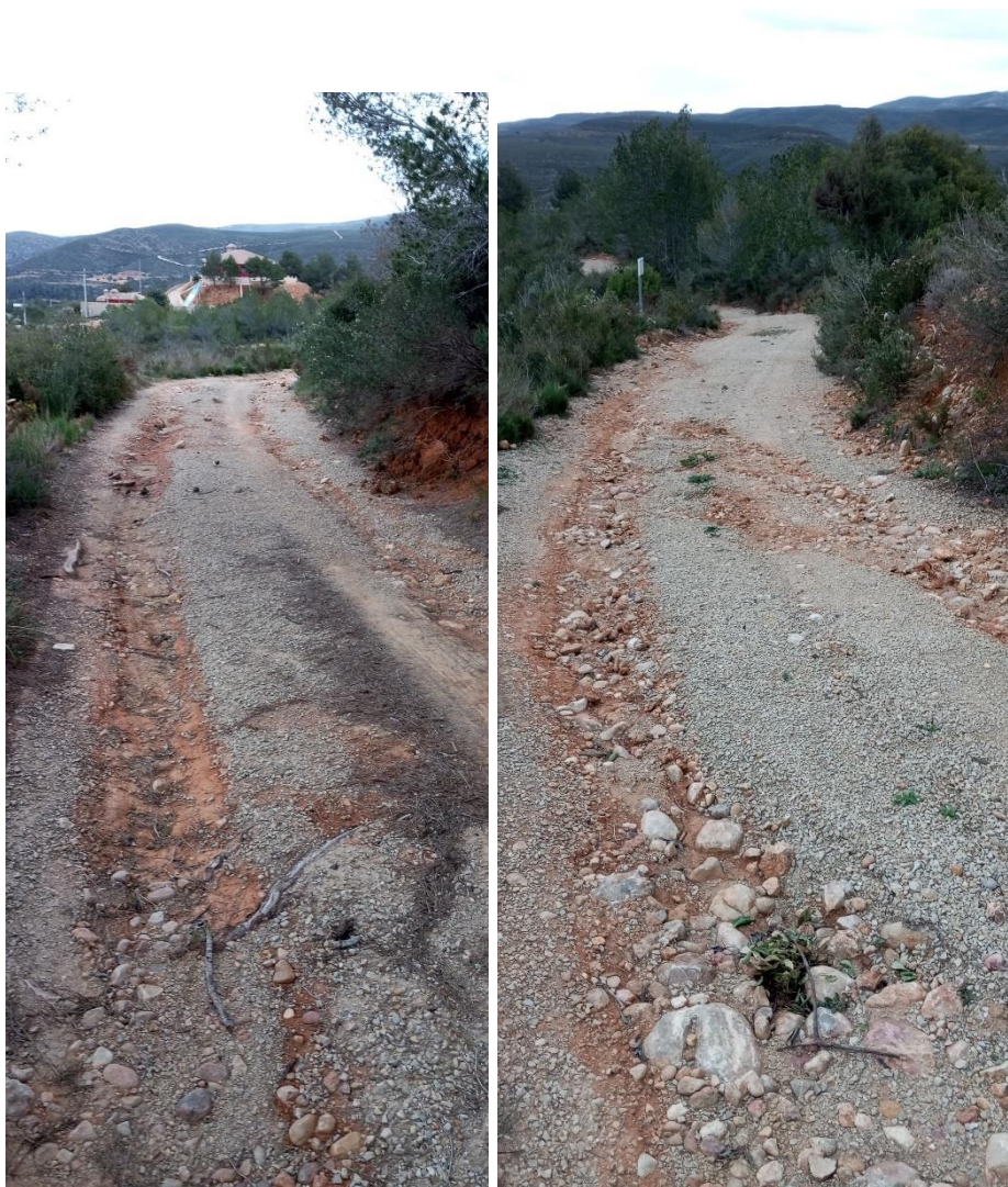
Imagen 7: Estado accesos depósito
