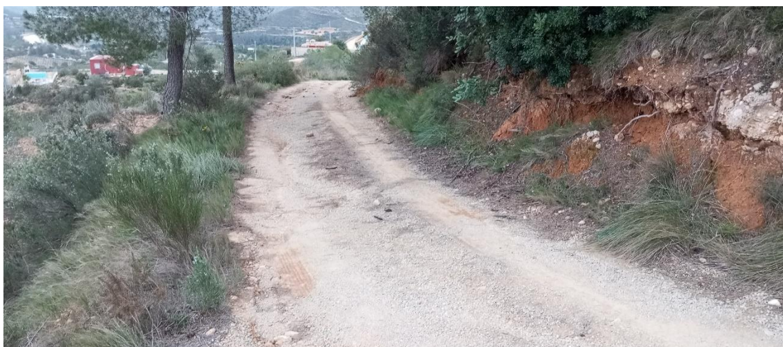
Imagen 6: Estado accesos depósito
