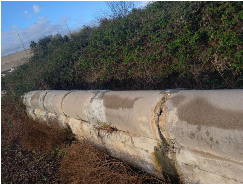
Colector residual con fugas
