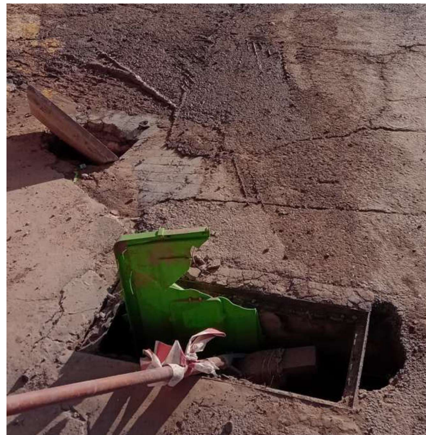
Ejemplo de imbornal dañado y rejilla extraviada
