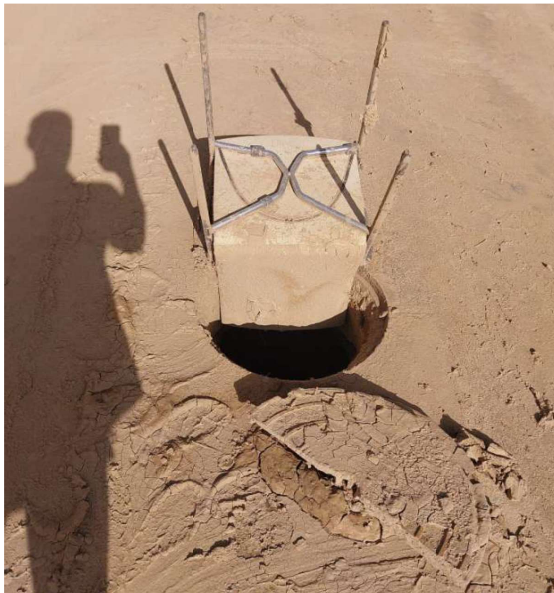
Ejemplo de pozo de registro con tapa extraviada/rota
