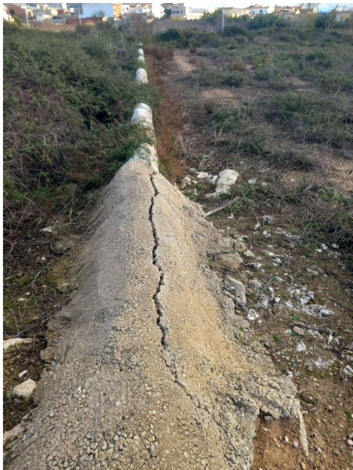
Deterioro del recubrimiento de hormigón
