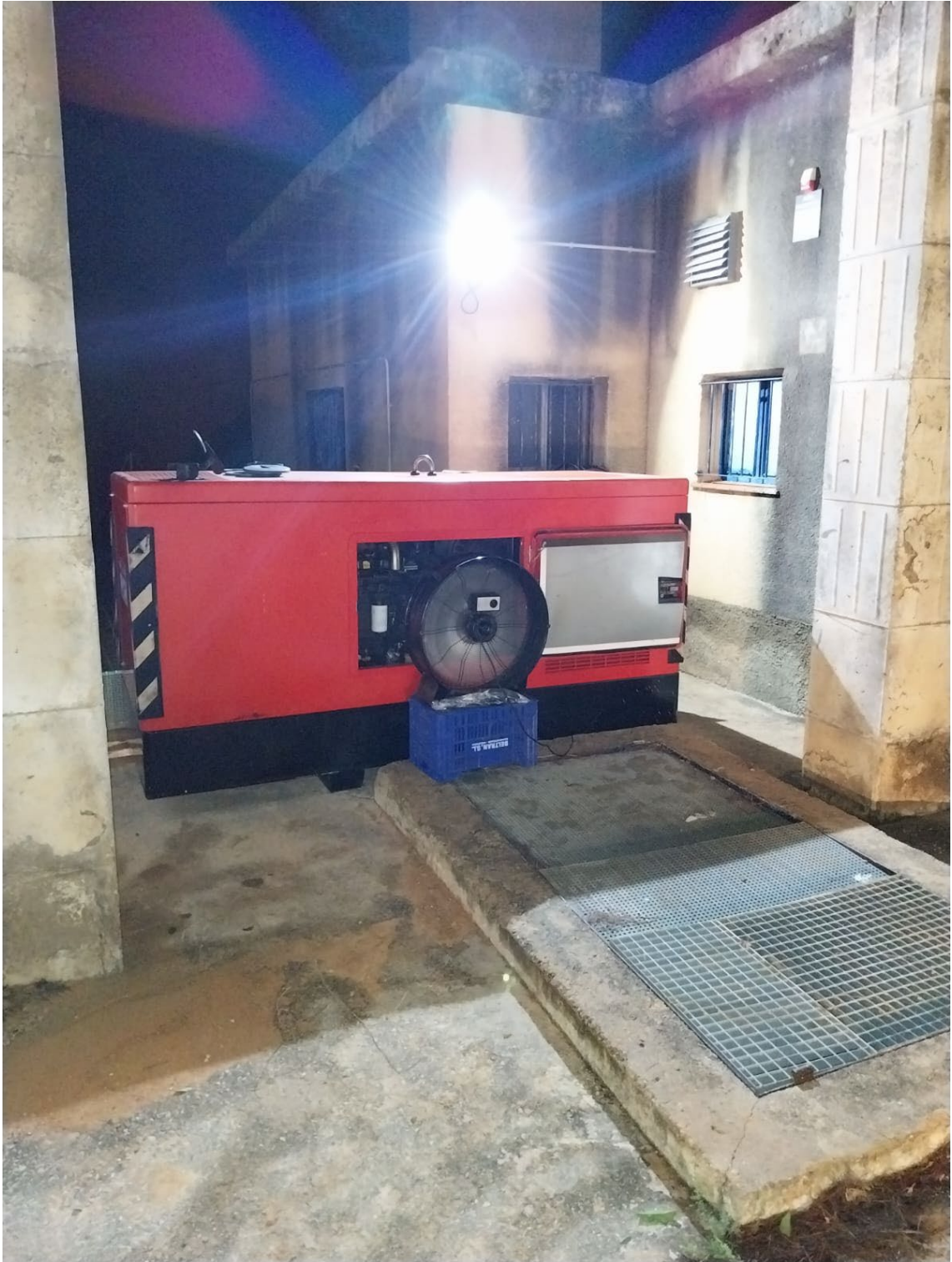
Grupo electrógeno en Pozo Les Colmenes
