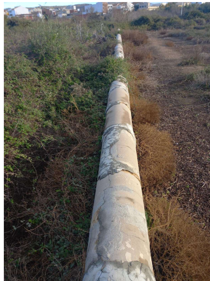
Colector residual en mal estado
