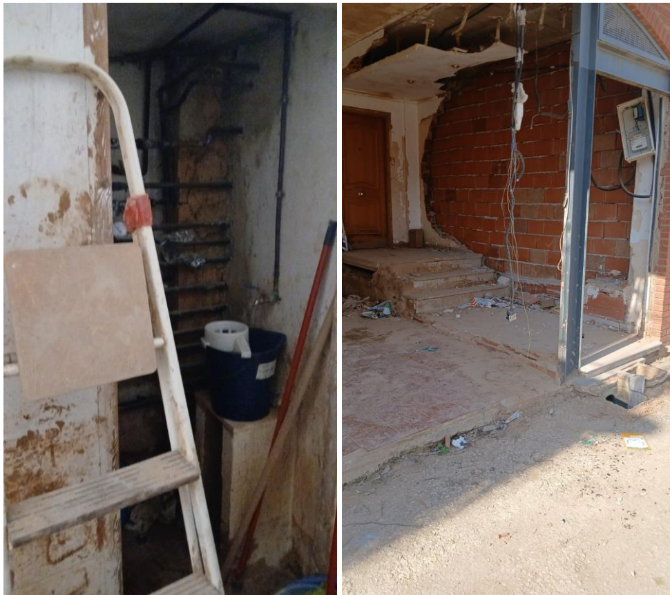
Imagen 23: Mal estado de contadores. Fase 1
