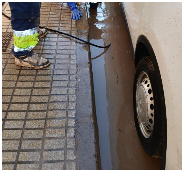
Imagen 14: Actuaciones Fase 0. Red de Saneamiento Casco Urbano. Obstrucción imbornal
