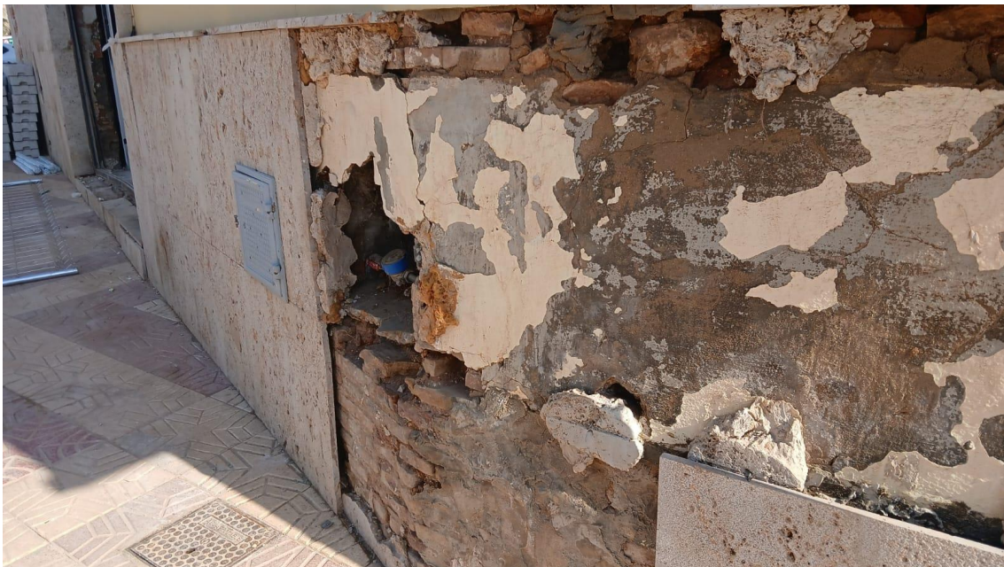
Imagen 24: Mal estado de contadores. Fase 1
