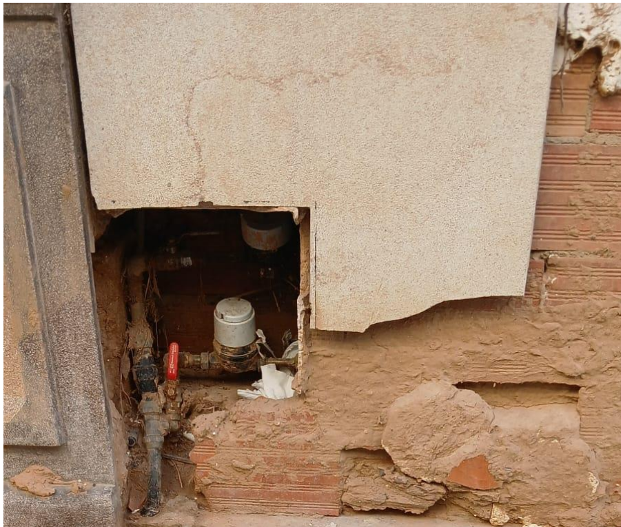
Imagen 25: Mal estado de contadores. Fase 1
