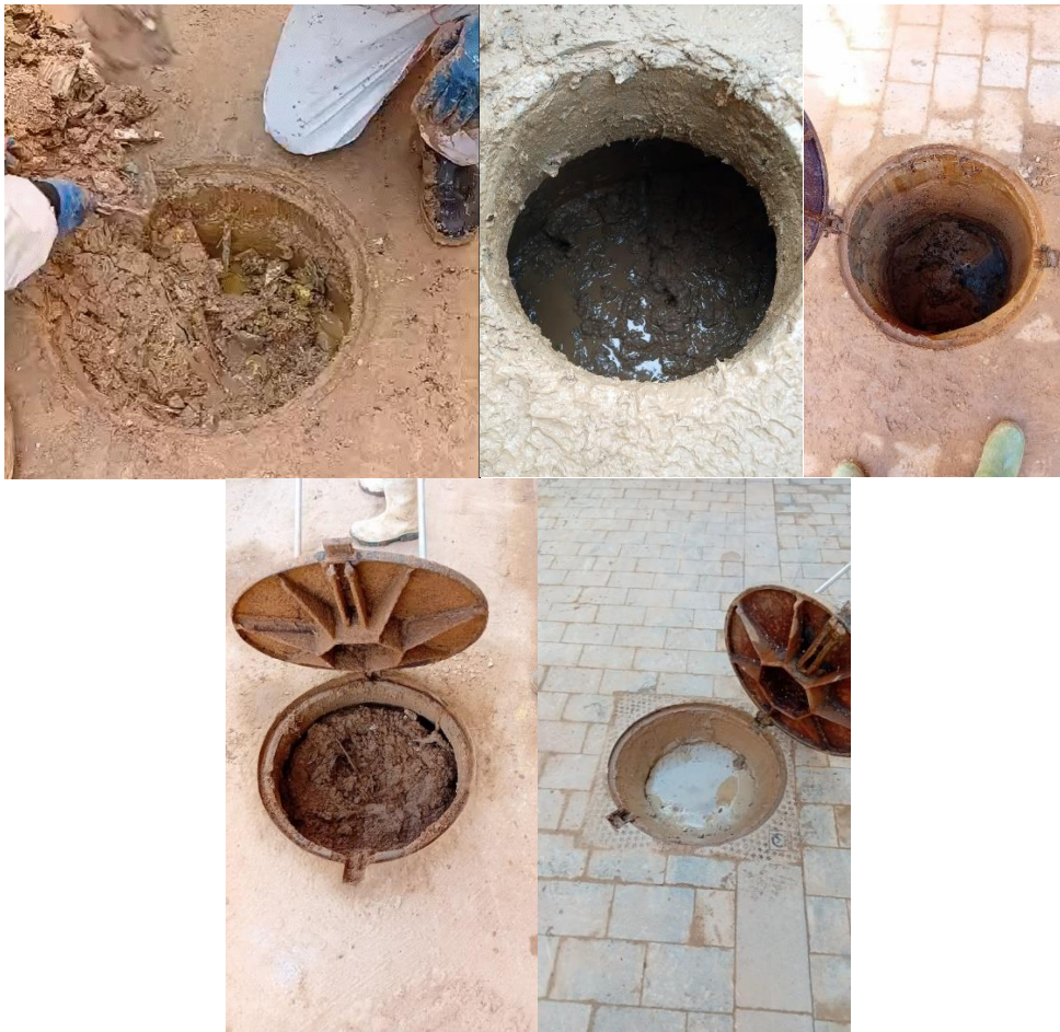
Imagen 13: Actuaciones Fase 0. Red de Saneamiento Casco Urbano. Colectores Obstruidos
