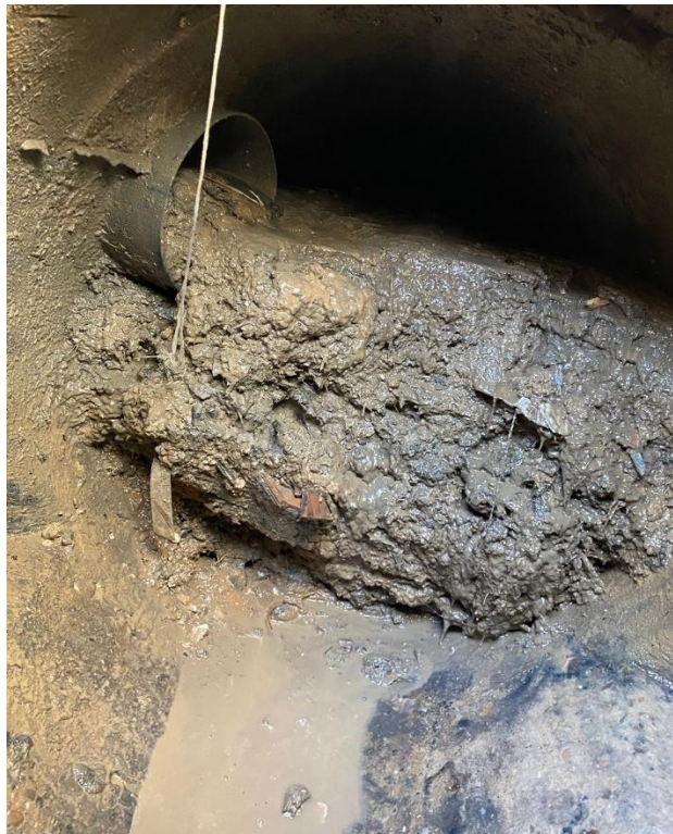
Imagen 11: Actuaciones Fase 0. Red de Saneamiento Casco Urbano. Obstrucción Colector
