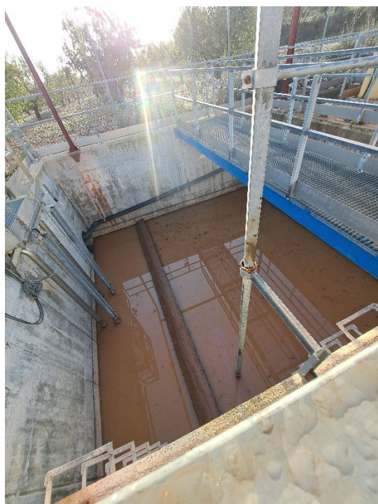
Imagen 7: Pozo de bombeo EDAR
