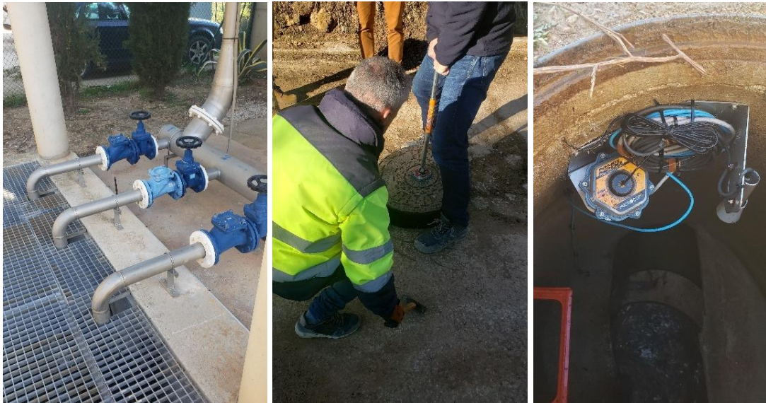
Bombas de agua bruta y sonda de medida en la entrada de EDAR. Fuente: Visita realizada (06-02-2025).
