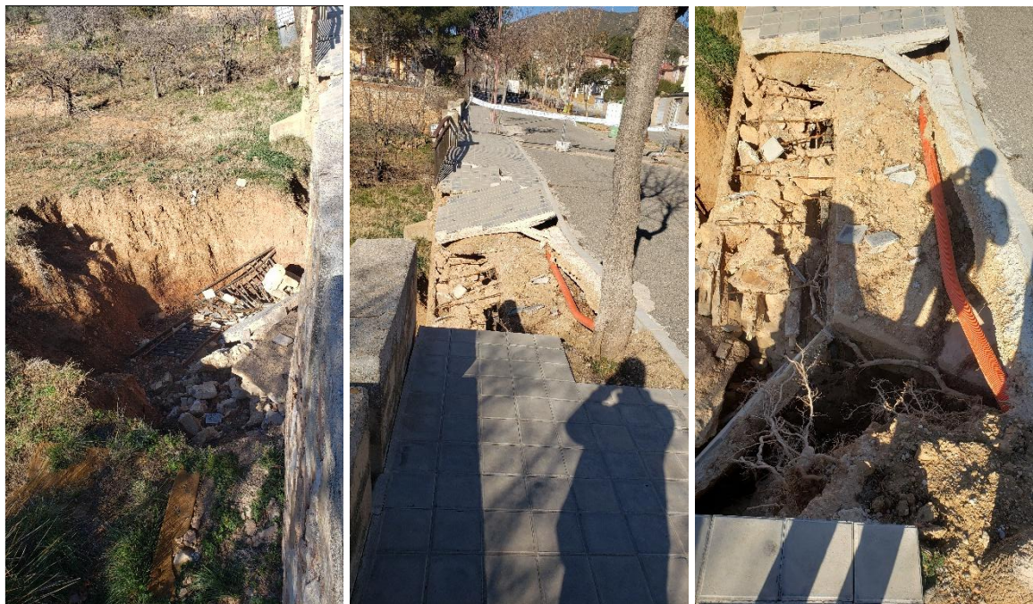
Afecciones en el puente sobre el barranco de El Pantano. Fuente: Visita realizada (06-02-2025).
