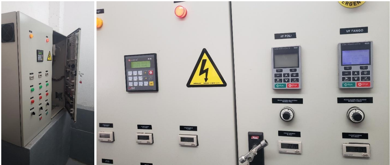
Variador de frecuencia en el interior del edificio de control. Fuente: Visita realizada (06-02-2025).
