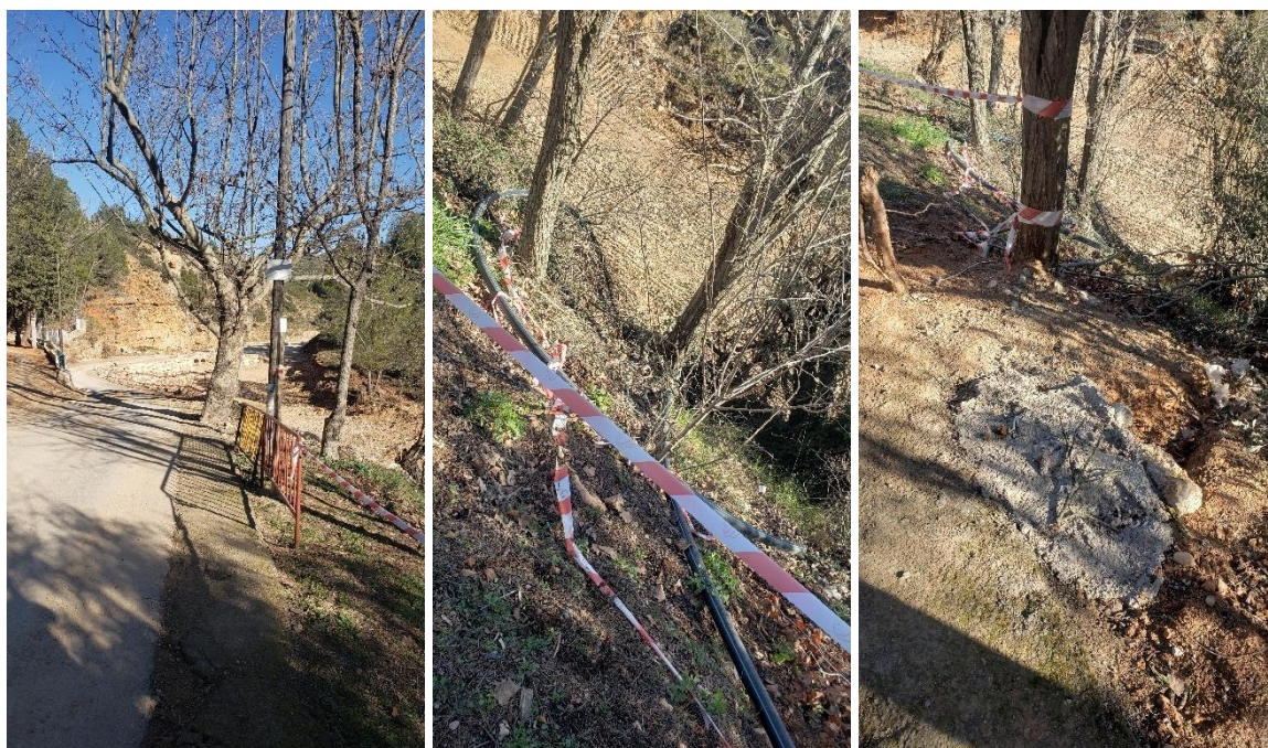
Conexión a la red de abastecimiento. Fuente: Visita realizada (06-02-2025).
