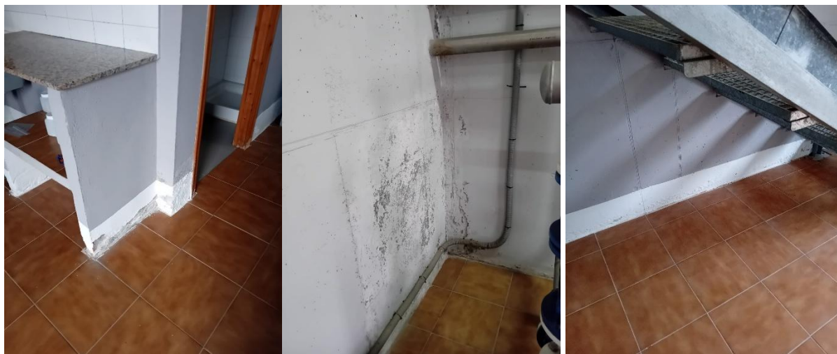
Afecciones en el interior del edificio de control. Fuente: Visita realizada (06-02-2025).
