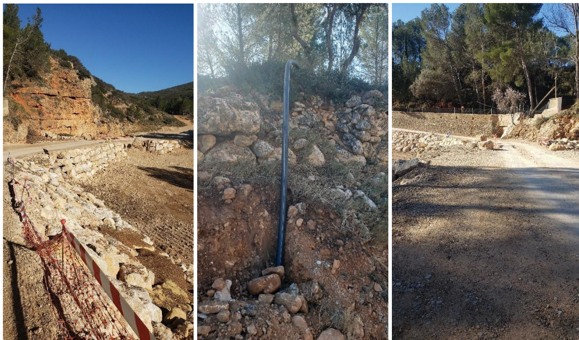
Conexión hacia el depósito de La Lloma. Fuente: Visita realizada (06-02-2025).
