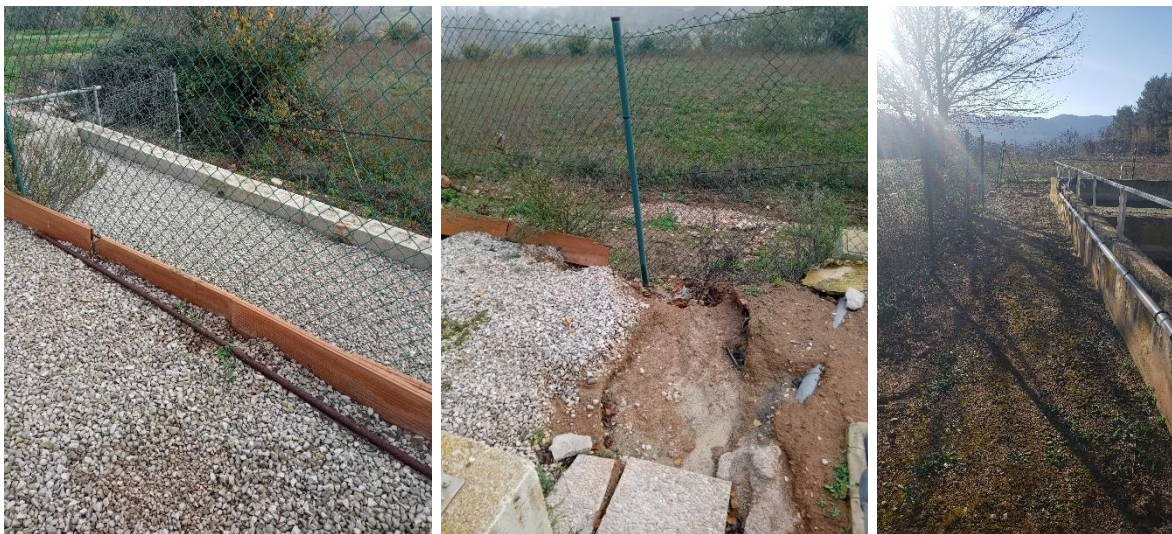
Pérdida de la gravilla del suelo de la parcela. Fuente: Visita realizada (06-02-2025).
