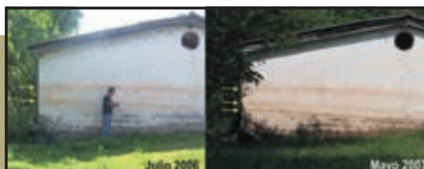
Figura 114. Tintado de la fachada de una edificación con marcas de varias inundaciones (a la izquierda dos niveles y a la derecha un nivel inferior adicional, generado por una inundación entre julio-2006 y mayo-2007).
