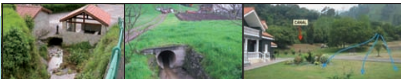
Figura 193. Criterios empleados en la zonificación de la peligrosidad torrencial. Izquierda y centro, descajamientos de cauces torrenciales agravados por drenajes soterrados con sección insuficiente. Derecha, morfología del depósito torrencial.
