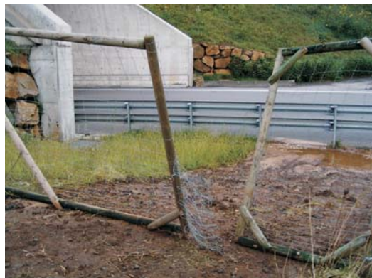
Figura 4.28. Puerta de acceso a un autovía en mal estado, permitiendo el paso de animales. Foto: Marc Fernández Bou.
