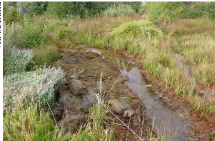
Obras de desecación de una turbera donde se asienta una colonia de hormiguera oscura.
