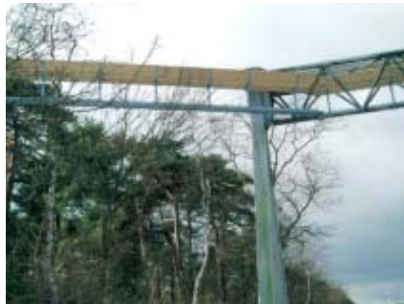
Figura 4.3 – Plataformas de madera instaladas en un soporte de señalización de una autopista. Foto: H. Bekker.
