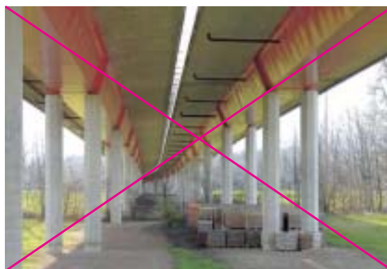
Figura 5.10 – Uso inadecuado de los terrenos situados bajo el viaducto. Foto: C. Rosell.
