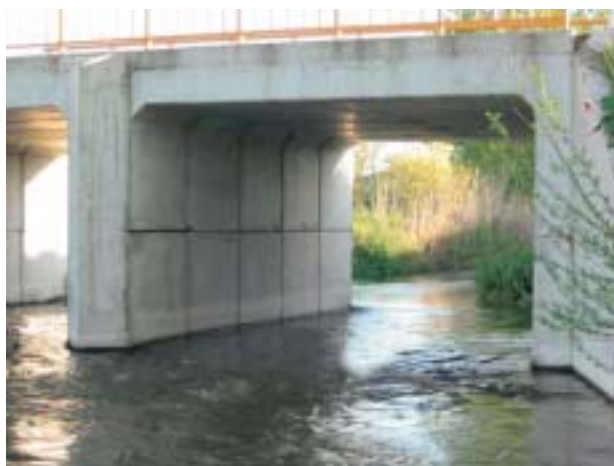
Figura 10.2 – Drenaje por el que discurre una lámina de agua permanentemente. Foto: J. García Molinos.
