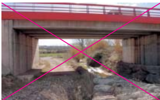
Figura 7.8 – La escollera dificulta el paso de fauna. Foto: F. Navàs.
