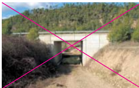
Figura 7.9 – Accesos al paso mal acondicionados. Foto: F. Navàs.
