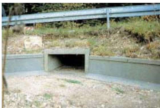
Figura 11.2 – El terreno adyacente a la estructura de guía se mantiene completamente liso y sin vegetación. Foto: COST 341.
