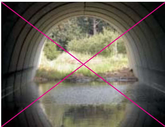
Figura 6.6 – La inundación completa de la base de la estructura dificulta el paso de la fauna. Foto: C. Rosell.
