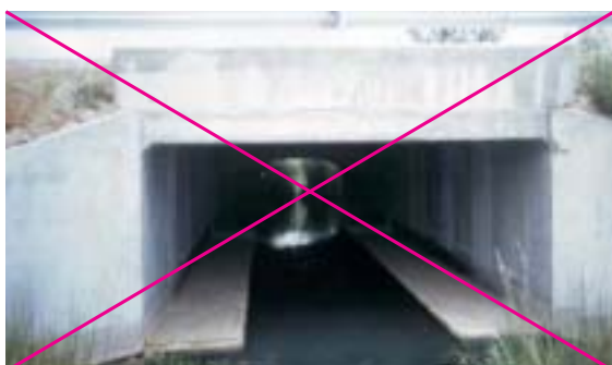
Figura 9.10 – Falta de rampas que conecten las franjas secas con las zonas adyacentes. Foto: F. Navàs.
