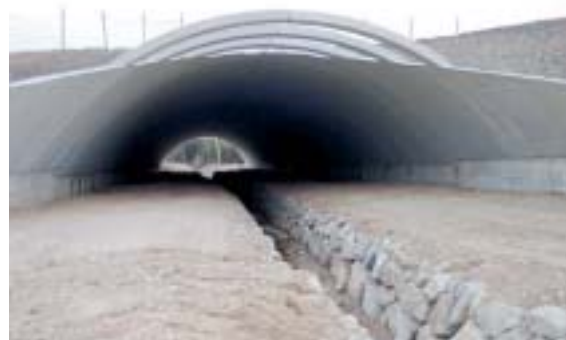
Figura 6.3 – Bóveda que permite una gran sección sin tabiques, antes de iniciar la restauración. Foto: C. Rosell.
