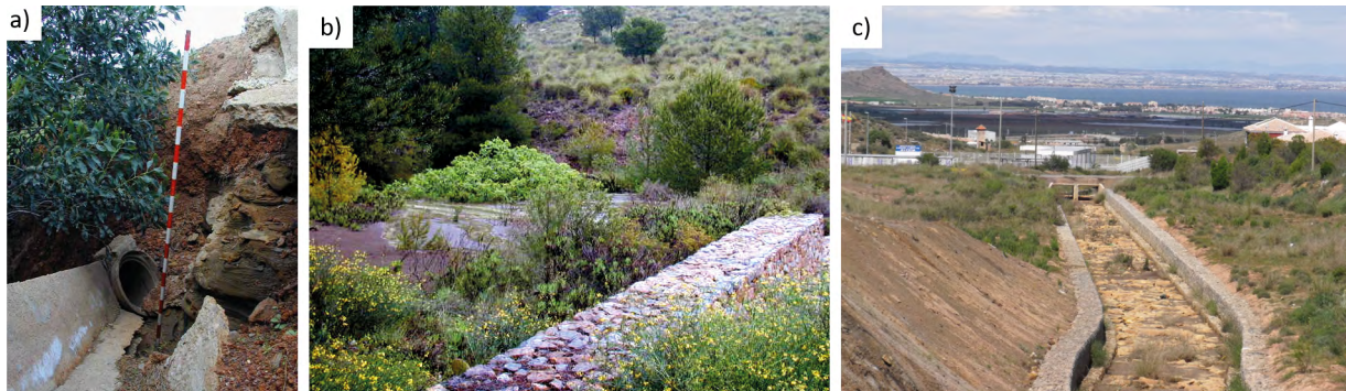
Figura 13. a) Ejemplo de un sistema de drenaje rígido con tubos de hormigón y canal de cemento en la presa de lodos Marqués de Pejar restaurada, es sistema está roto y desconectado más de dos metros, b) un sistema de drenaje flexible con gaviones en la rambla de Portman y c) sistema de drenaje flexible con gaviones en la rambla del Beal.
