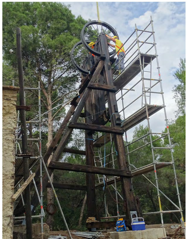
Figura 6. Castillete de madera caído, y restaurado, mina Santo Tomás (Peña del Aguila).
