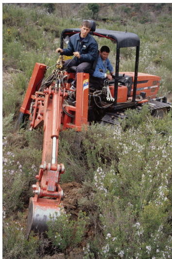
Figura 21.6. Adaptación a un tractor de cadenas de un equipo de trabajo para excavar hoyos con dos patas estabilizadoras. Esta adaptación carece de cualquier homologación de seguridad (foto: J Pemán).
