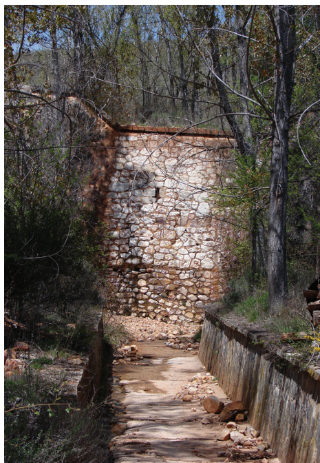
Figura I.10. Dique de cierre en el arroyo del Pueblo. El vaso está completamente aterrado. Al pie del paramento se aprecian los materiales aportados por la última avenida (foto: JA Fernández).
