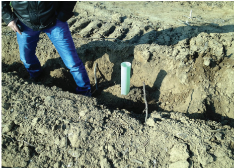
Operación en suelo arenoso con surco abierto demasiado profundo, de tal manera que éste supera la altura de la planta.
