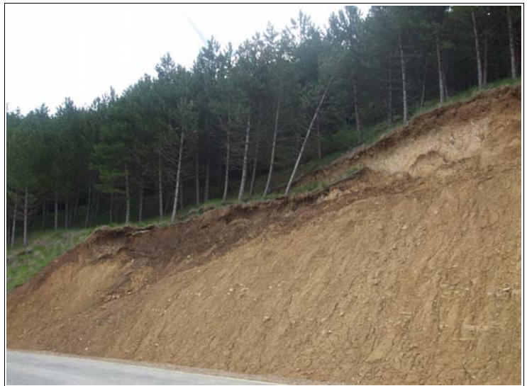
Imagen nº 35: Deslizamiento de un talud en el Puerto de Sos.
