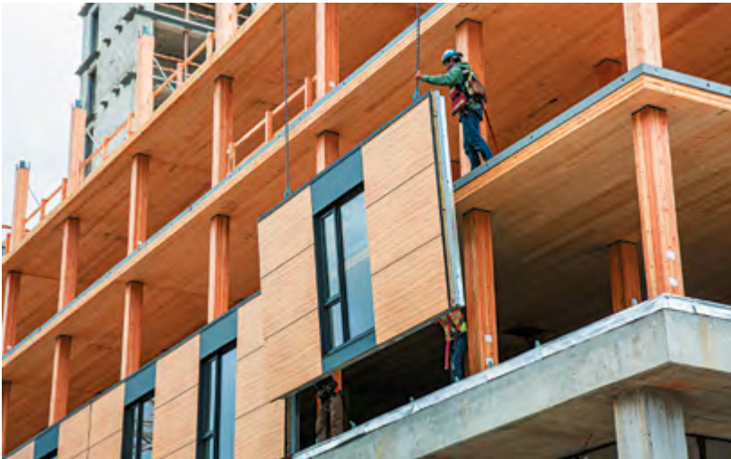
Foto 4. Paneles de estructura de acero y cerramiento de madera en el edificio Brock Commons Tallwood House de la Universidad de Columbia Británica (fotografía de K.K. Law, cortesía de Naturally Wood).
