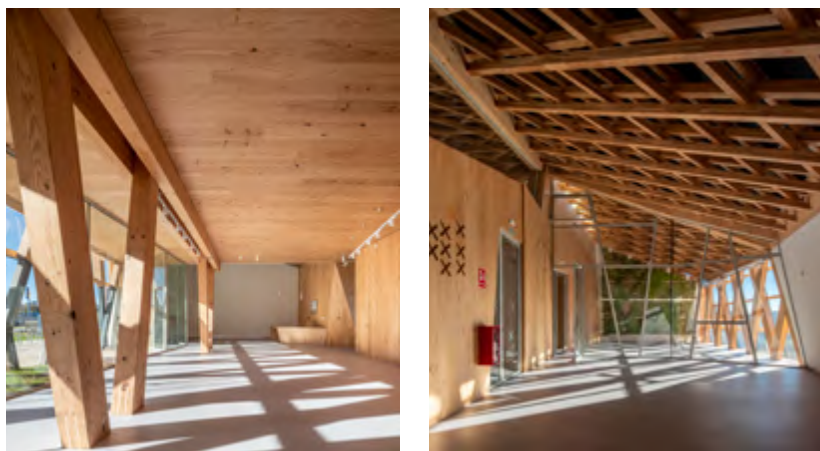
Figura 11: Planta baja, con todos los elementos estructurales de Pinus radiata (izq.) y planta de cubierta, con las celosías multicapa de Eucalyptus globulus (dcha.). Fotografías: Héctor Santos-Díez.
