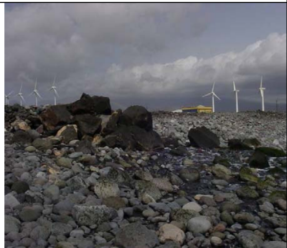
Descarga enterrada en una playa de bolos. Desaladora de Arinaga, Gran Canaria.
