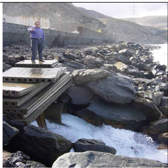
Chorro libre sobre la escollera de un dique. Desaladora Las Palmas III
