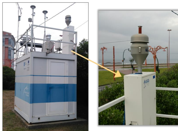
Imagen 3. Captador Digitel DHA-80 instalado en Torre de Hércules para muestreo de PM10.
