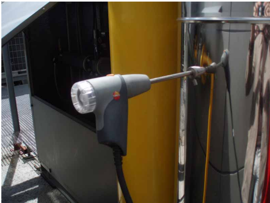
Foto 3.6. Analizador de gases en caldera (Fuente: Geoter).
