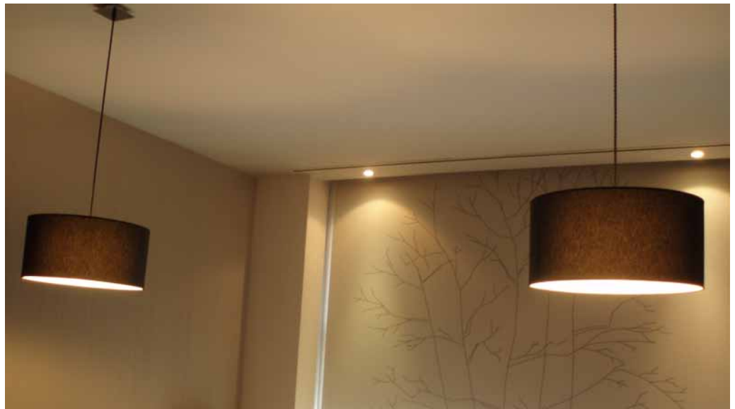
Foto A3.5. Iluminación interior en una habitación del hotel Madrid Norte (Fuente: Rafael Hoteles).
