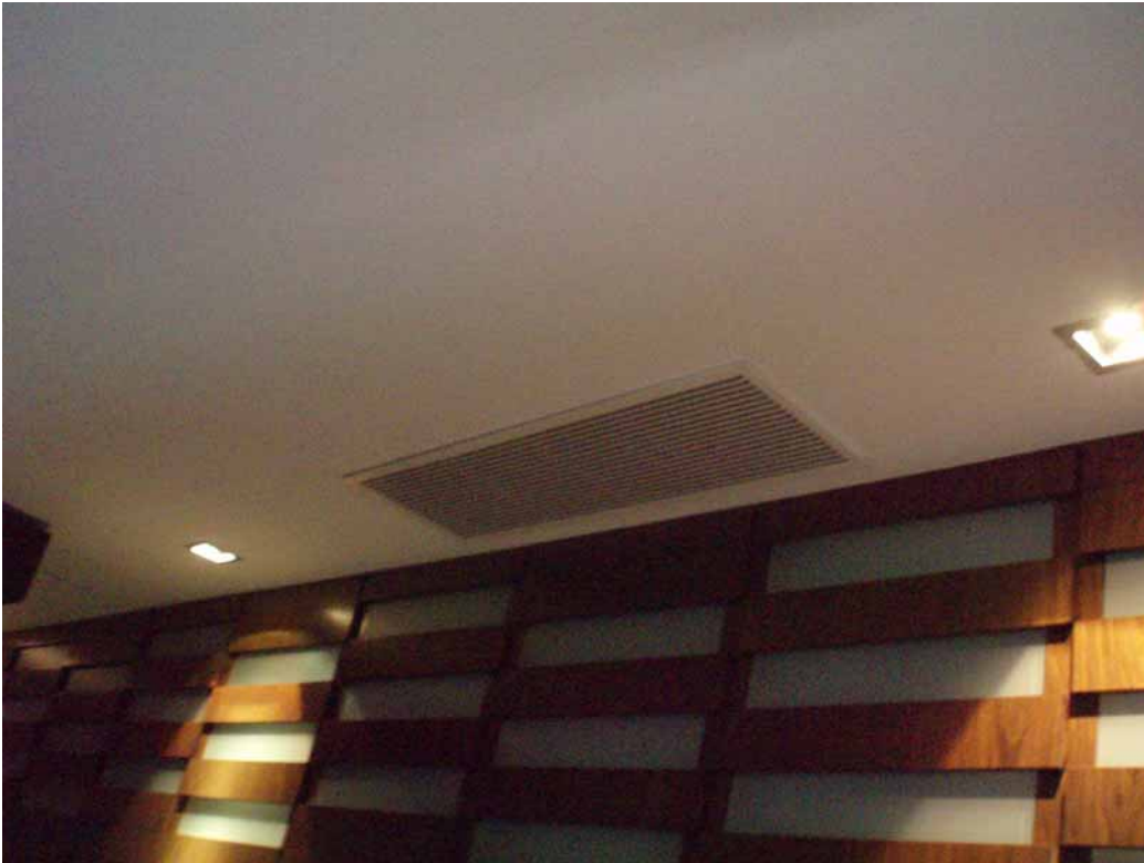
Foto 3.7. Climatización del lobby del hotel Madrid Norte (Fuente: Rafael Hoteles).
