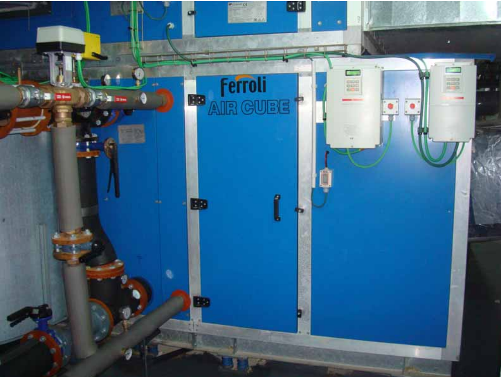
Foto A2.6. Equipo climatizador (Fuente: Ferroli).
