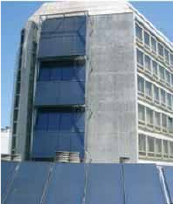
Foto 1.3. Instalación solar térmica en el hotel Husa Princesa de Madrid.
