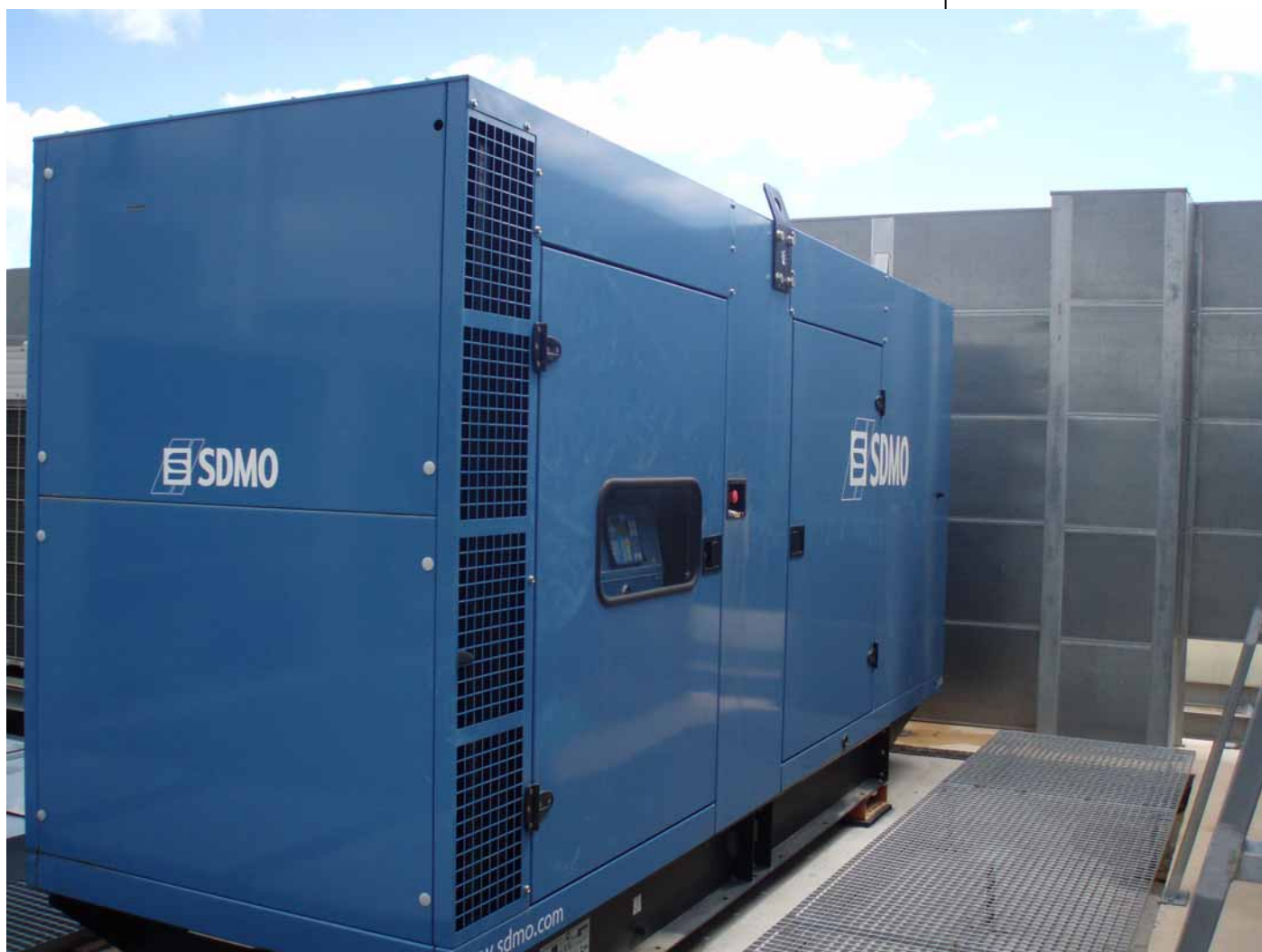
Foto A1.11. Grupo electrógeno instalado en el Hotel Madrid Norte (cortesía de Rafael Hoteles).
