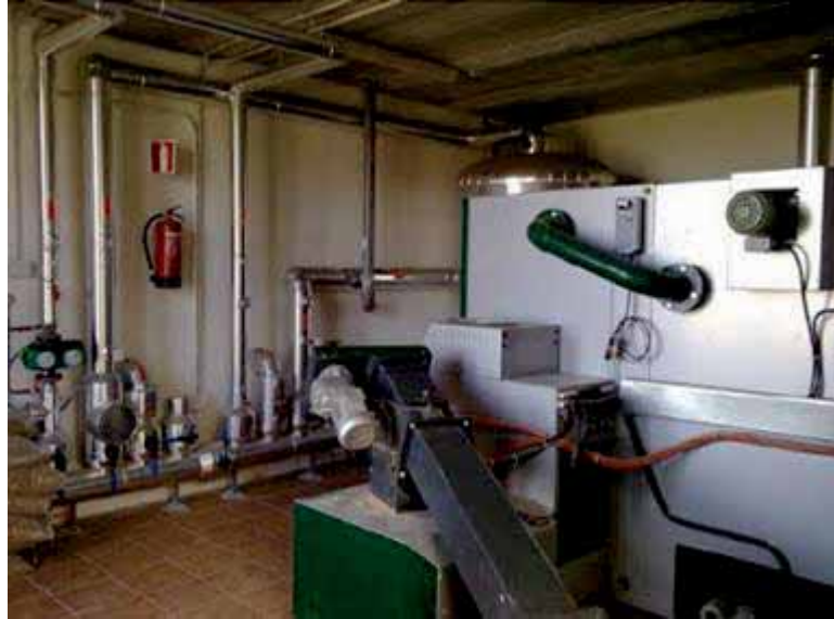
Caldera de biomasa del edificio principal del CENEAM
