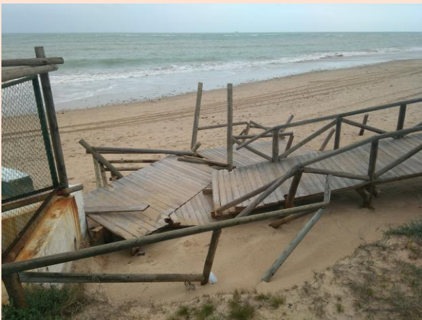
Ilustración 3: Daños en acceso, en el cordón dunar y el canal
