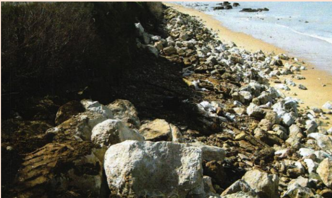
Ilustración 9: Defensas de la línea de costa dañados..
