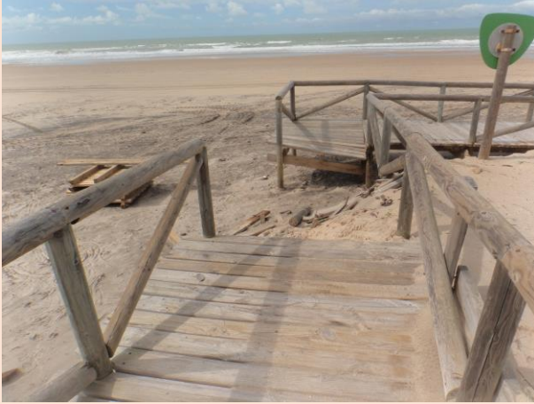
Ilustración 1: Accesos destruidos en la Barrosa
