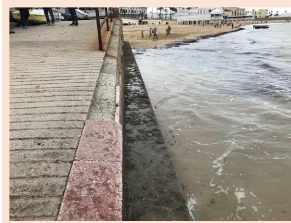
Ilustración 1: Daños en el alfeizar
