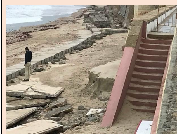
Ilustración: Daños superficiales en el muro
