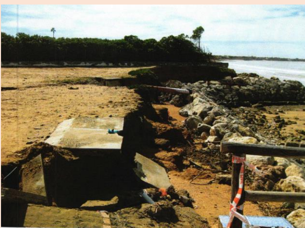
Ilustración 5: Muro de escolleras deteriorado en playa de Montijo
