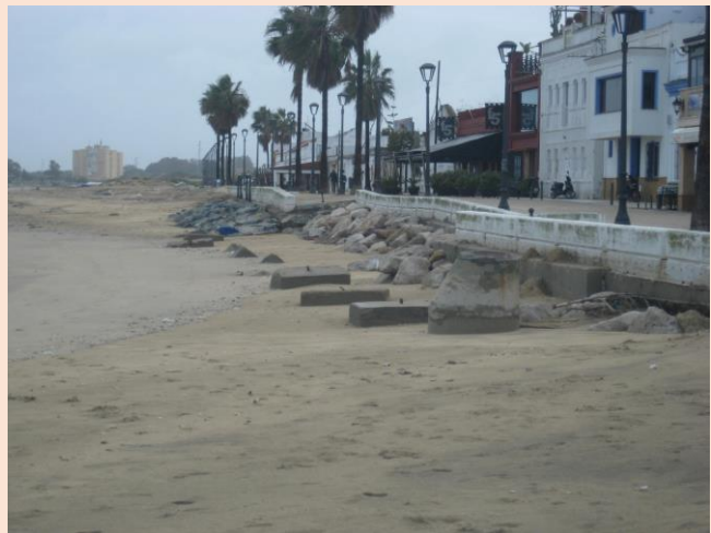
Ilustración 4: Defensas de costa dañadas y elementos urbanos dañados
