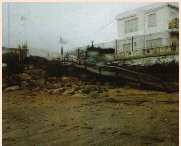
Ilustración 6: Acceso y protección deteriorados en Montijo
