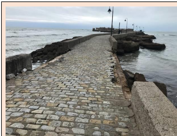
Ilustración: Tramos con pérdida total del muro
