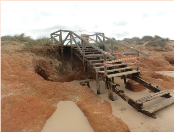
Ilustración 3: Daños en accesos y perdida de arena
