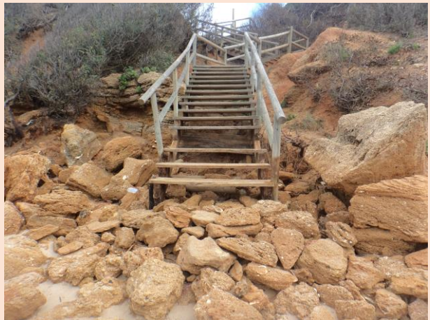
Ilustración 4: Detalle estimativo de la perdida de arena en la playa de las Piedras y acceso dañado.
