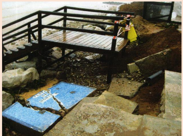
Ilustración 4: Elementos urbanos deteriorados
