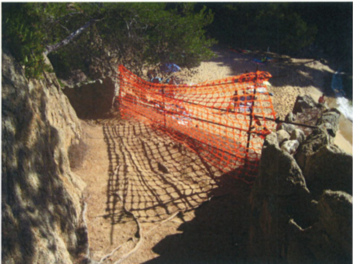
F3 – Estado actual muros.
