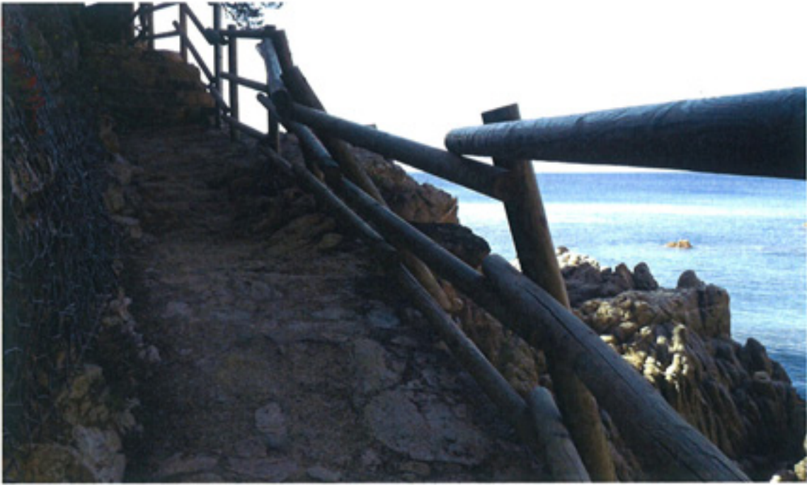
F4- Barandilla de madera a repara.
