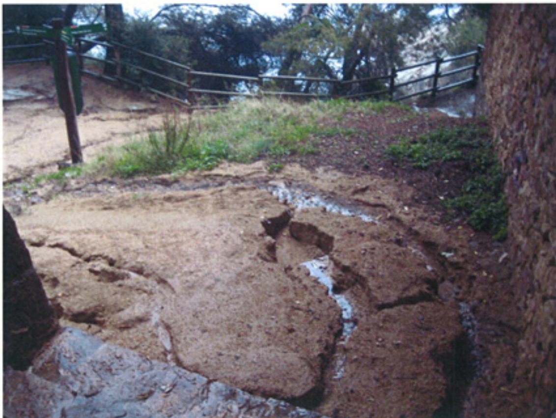
F1- Estado actual del mirador
