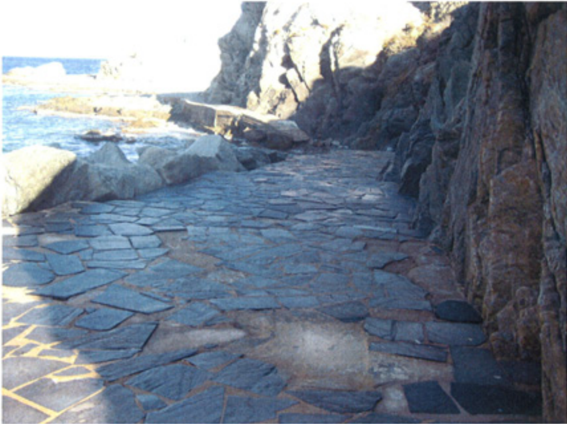
F1- ZONA INICIO AFECTADA PAVIMENTO EN CALA CLISQUES
