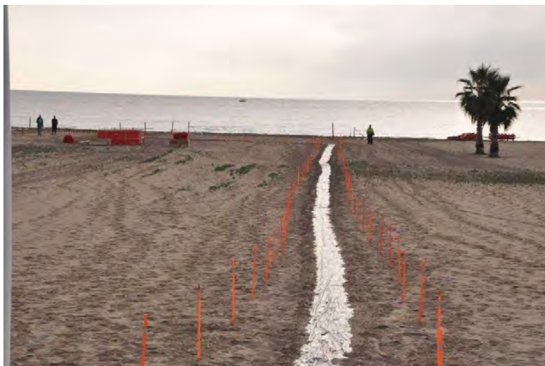
Figura 8: Pasillos y almacenaje de residuos
