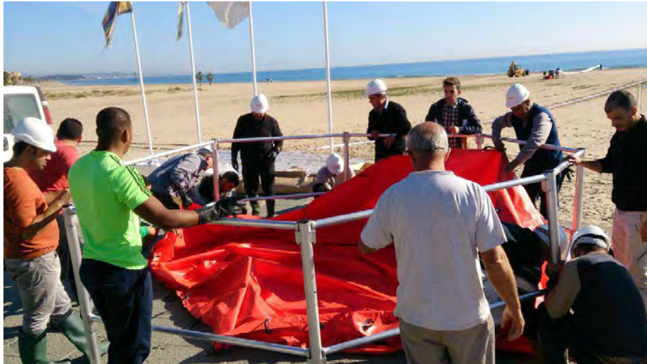
Figura 7: Depósito 10.000 L con estructura metálica
