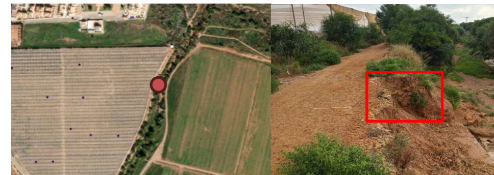
Ilustración 28. Posible muro afectado por las remociones de tierra o desprendimientos de avenidas de agua.
