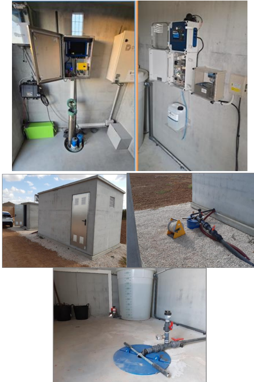
Figura 33. Sondeos y equipos de medida. Arriba izqda.: sondeo con la primera sonda de medida de nitratos en continuo instalada; arriba dcha.: mini laboratorios portátiles; centro izqdo.: vista exterior de las casetas en cuyo interior se ubican los sondeos y equipos de medida; centro dcho.: pozo de bombeo para movilizar las aguas del acuífero de manera previa a las mediciones; abajo: sondeo de extracción y depósito de recogida del agua de los minilaboratorios.
