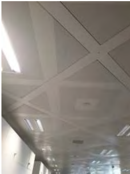
Detalle de sistema de luminarias y falsos techos microperforados
