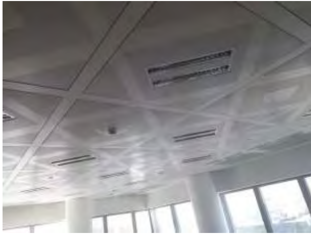
Detalle de sistema de luminarias y falsos techos microperforados
