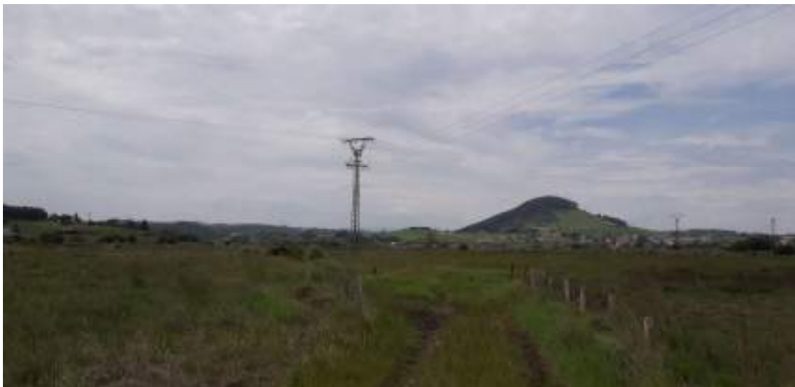
Foto 4: Apoyos AV72188 y A24910 dentro de la zona de Dominio Público Marítimo-Terrestre.
