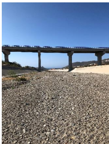
Fin zona extracción
