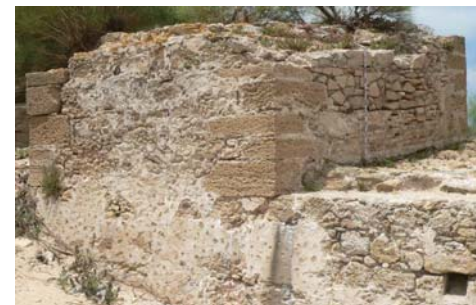
Figura 4. Reparaciones en tronera.
