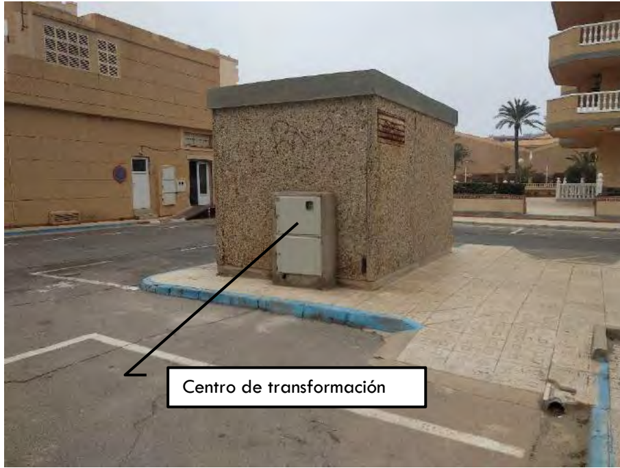
FOTOGRAFÍA N° 12: Servicios Afectados. Centro de transformación.
