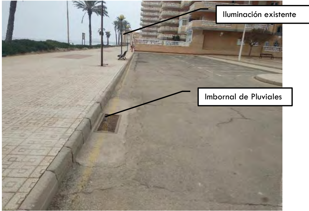
FOTOGRAFÍA N° 16: Servicios Afectados. Pluviales e iluminación
