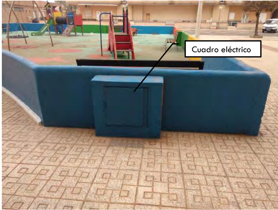
FOTOGRAFÍA N° 10: Servicios afectados. Cuadro MT
