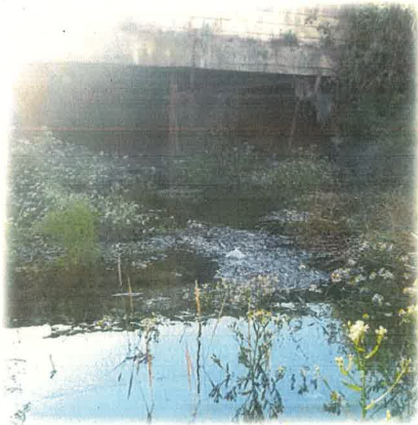
Estado de los tubos arroyo Juanes aguas arriba de carretera BI-3797
