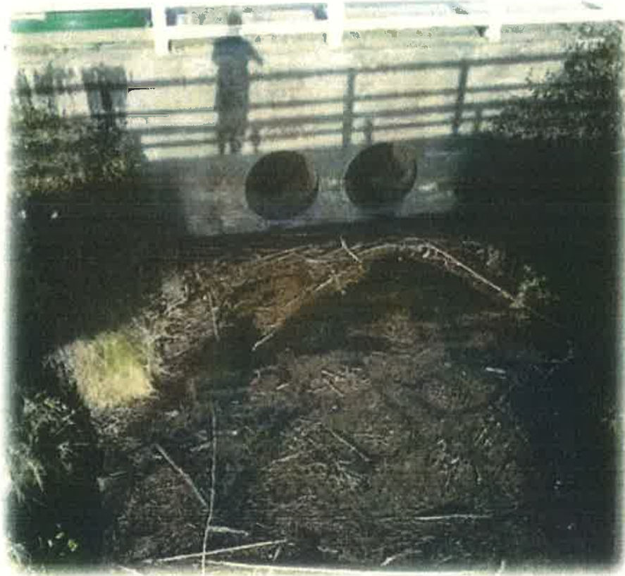
Estado de los tubos arroyo Juanes aguas abajo de carretera BI-3797
