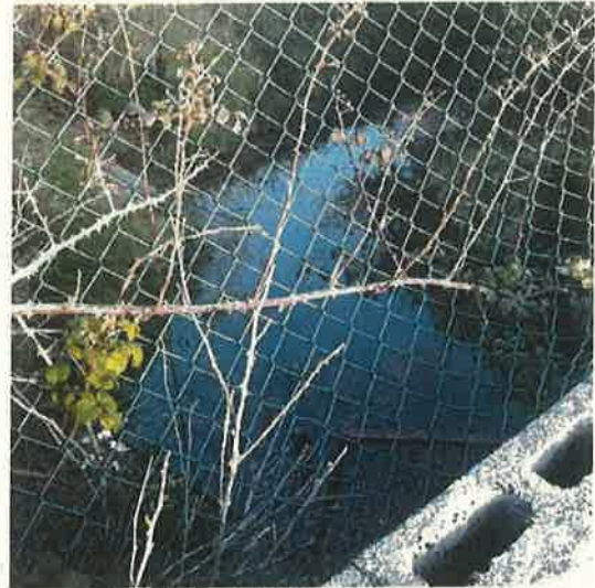
Foto 18: Marea alta aguas arriba paso carretera
