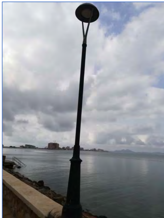
Imagen 25. Tipología de luminaria instalada en paseo marítimo
