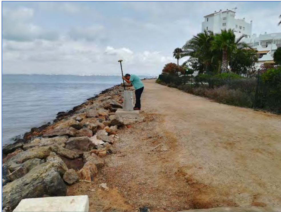
Imagen 22. Levantamiento con GPS de los hitos del DPMT y Vista general de paseo marítimo a pavimentar
