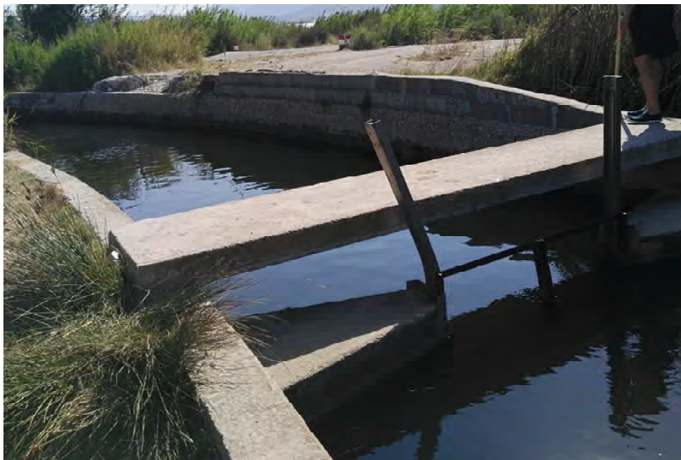
Guías de compuertas doblados y compuertas rotas o extraídas.
