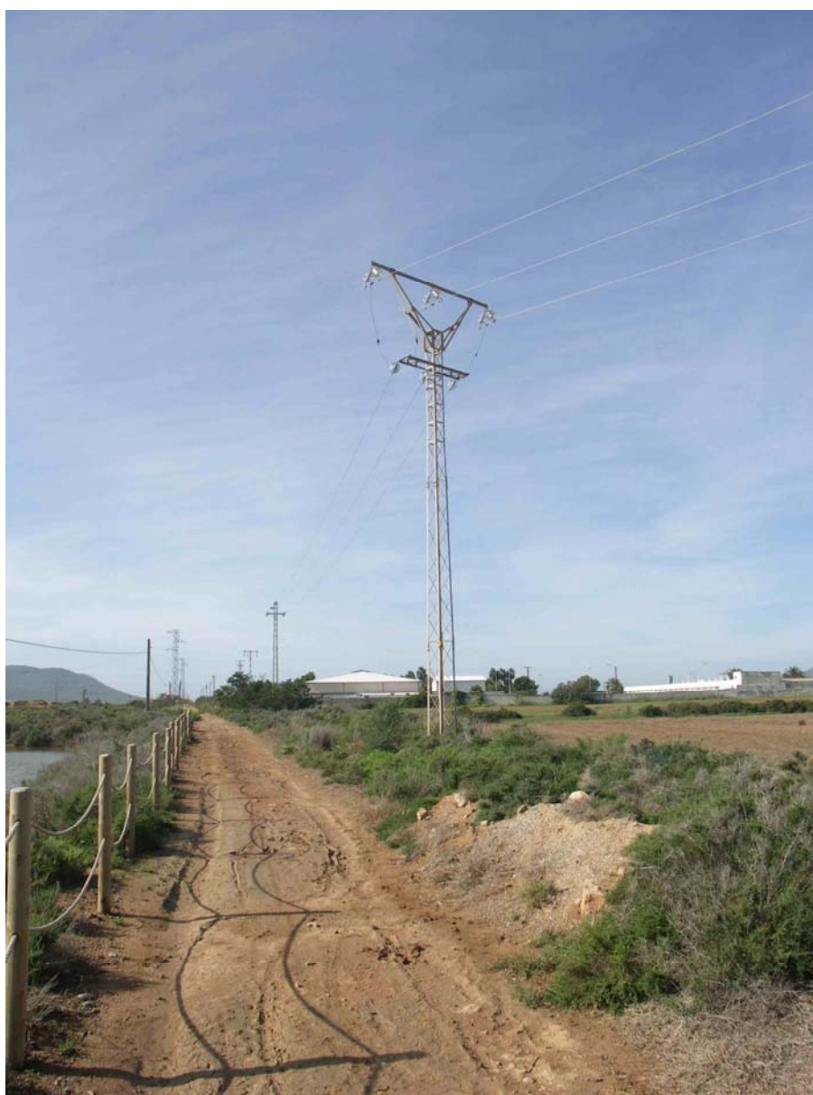
Foto 12. Apoyo que se proyecta sustituir por otro para el bajado de líneas. Se halla a 40 m del cauce.
