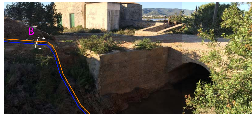
Salida de perforación en topo, pasando por debajo de la carretera y el canal hasta llegar a la zona del transformador CD Es Ros 30620 (f 02)
