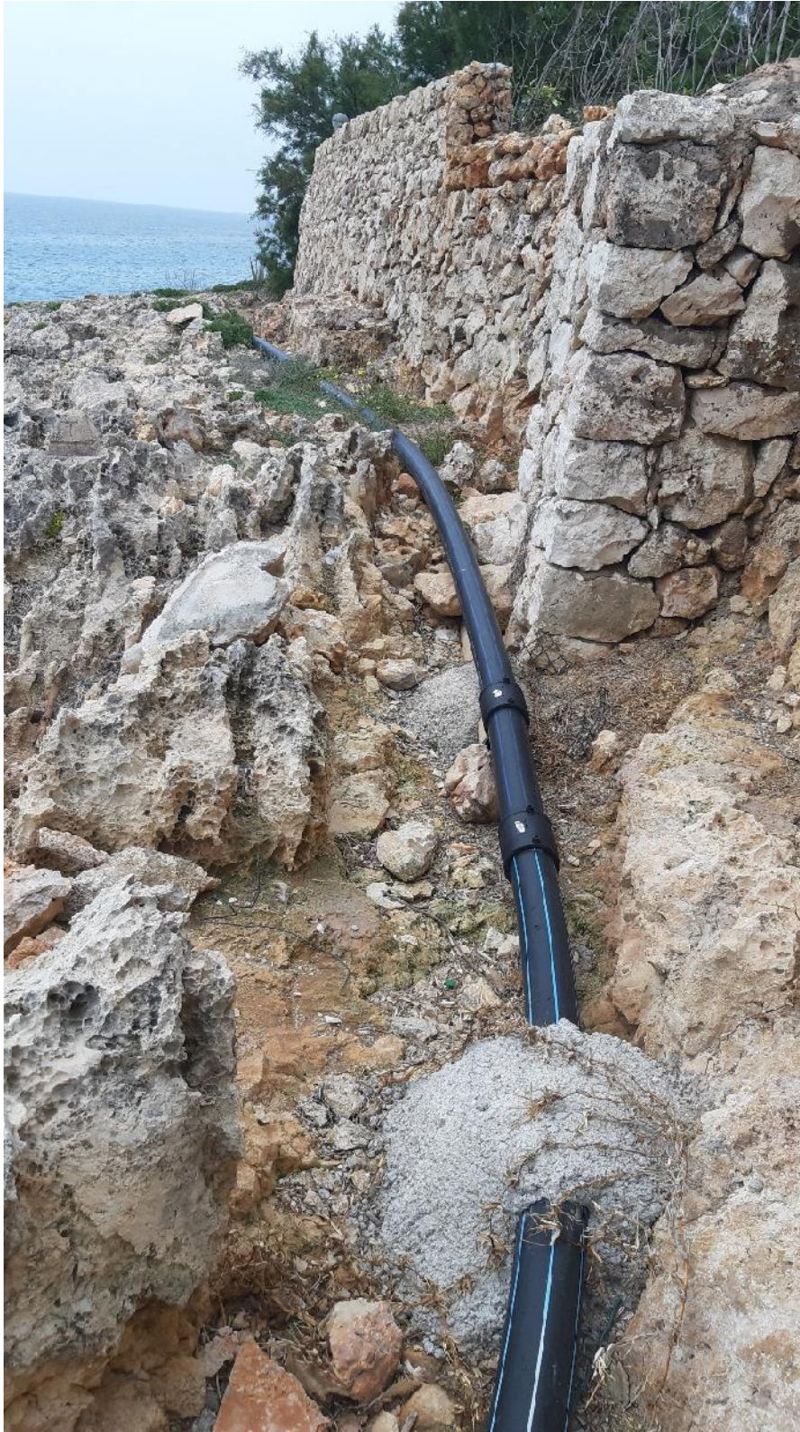
Foto Secuencia Foto: Foto 14: Tramo superficial conducto impulsión
