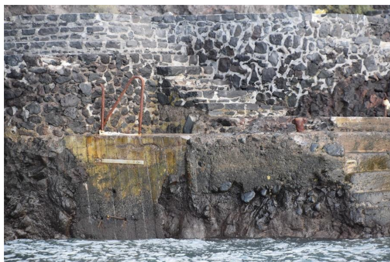
Foto 51. Escalera demolida y hierros sueltos en la base
