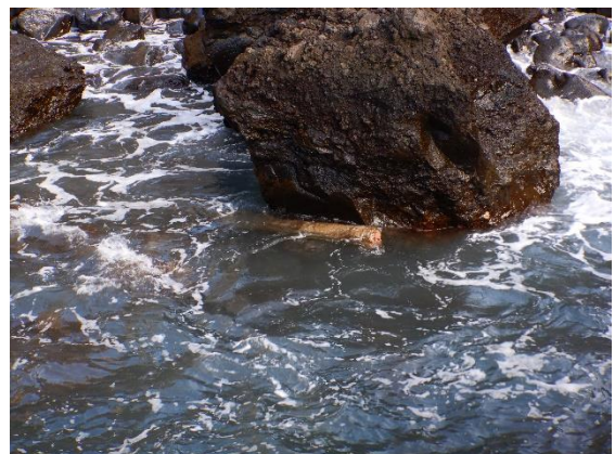
Foto 56. Resto de pilar de apoyo de la pasarela en el mar
