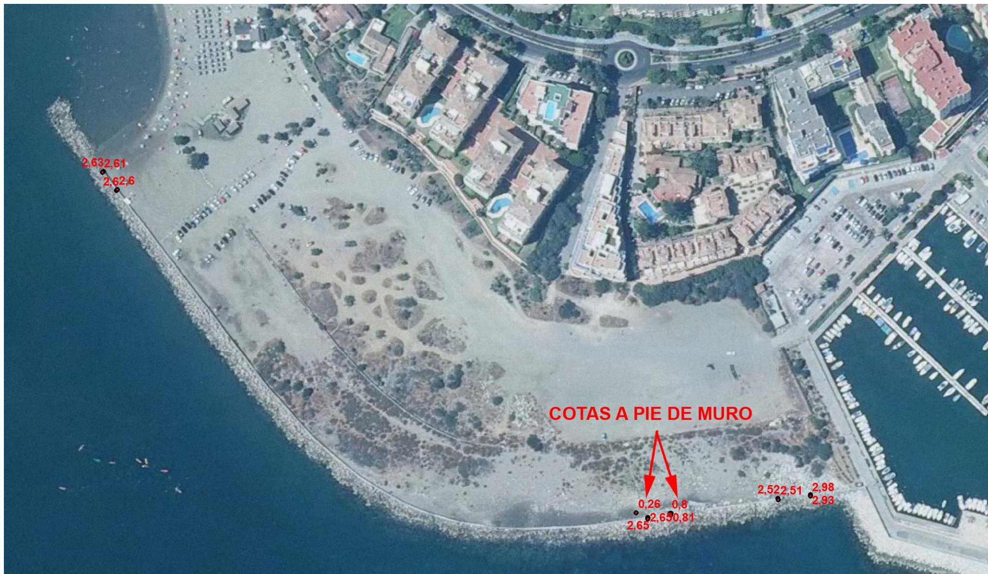
Capturas G.P.S. de puntos de la parte superior del muro, y dos puntos a pie de muro en una de las zonas de desmoronamientos.
