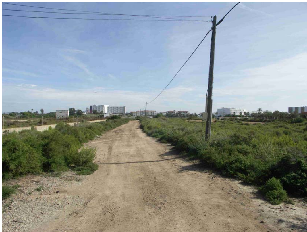
Foto 26. En este tramo, también afectado por la ruta peatonal y ciclista, se elimina el tendido telefónico y se instala línea soterrada.
