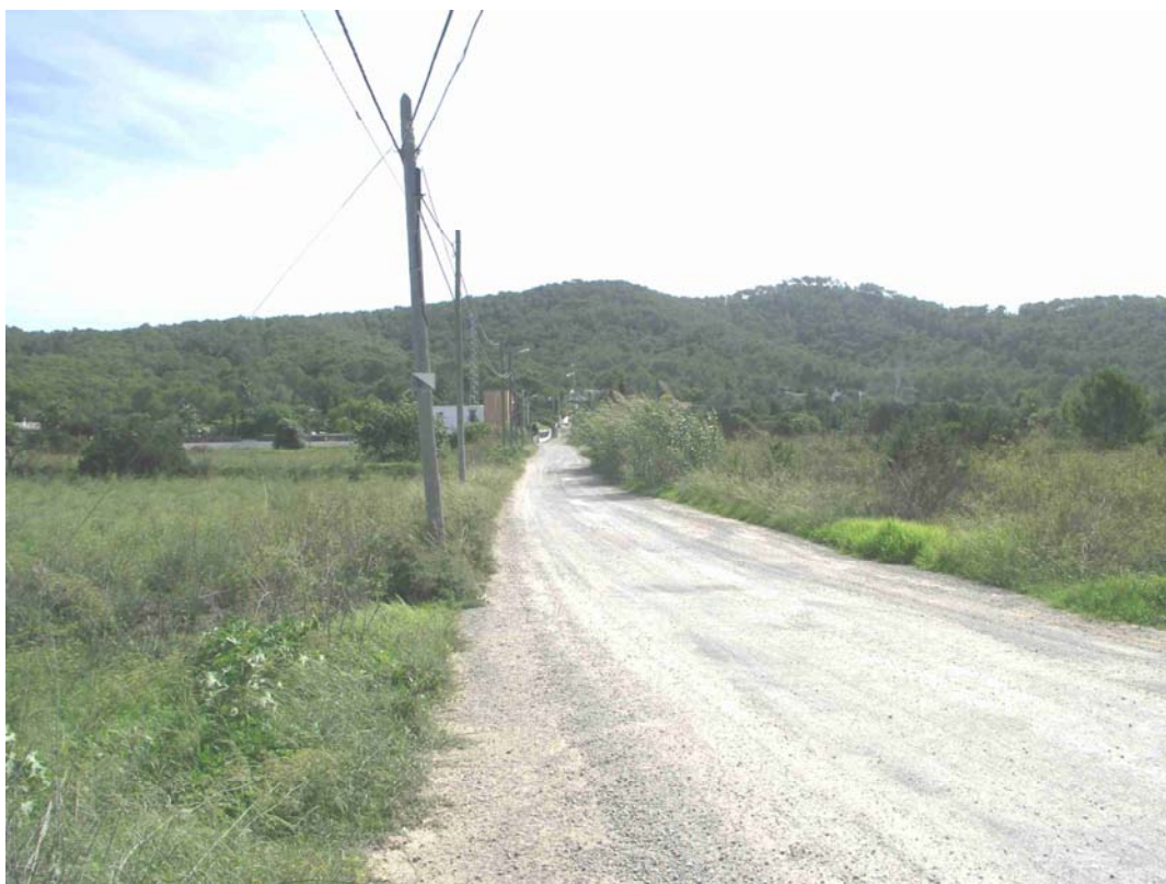
Foto 57. Tramo de camino ascendente hacia el este, afectado por retirada de tendido telefónico e instalación de nuevas líneas soterradas de MT y telefonía.
