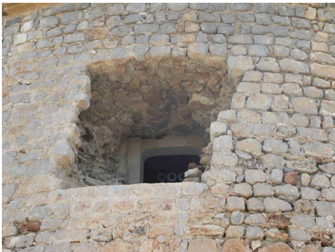
Foto 40. Detalle del ventanal a reconstruir.
