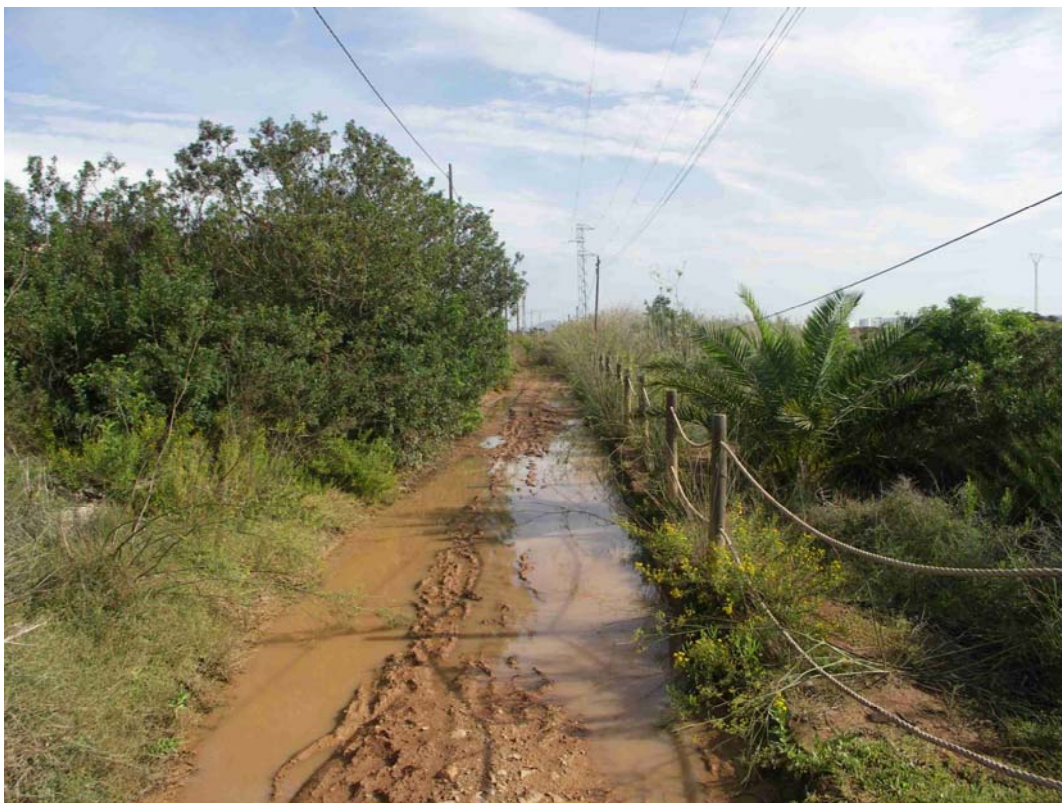
Foto 17. Volviendo hacia el camino afectado por el sendero peatonal y ciclista. Zona muy encharcable, a causa de la naturaleza de los suelos y del mal drenaje del camino.
