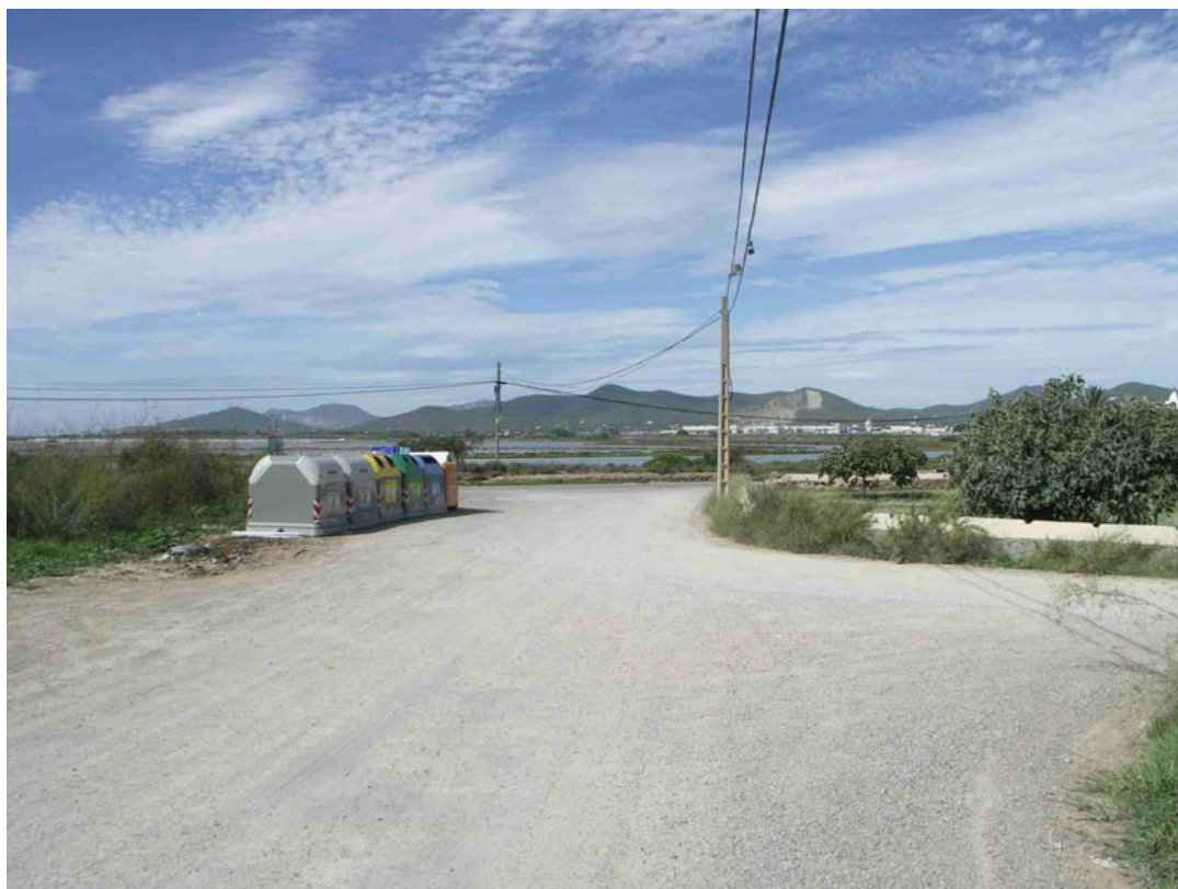
Foto 58. Hacia el oeste, desde el mismo cruce, tendido telefónico que cruza la carretera PM-802, y que será eliminado.
