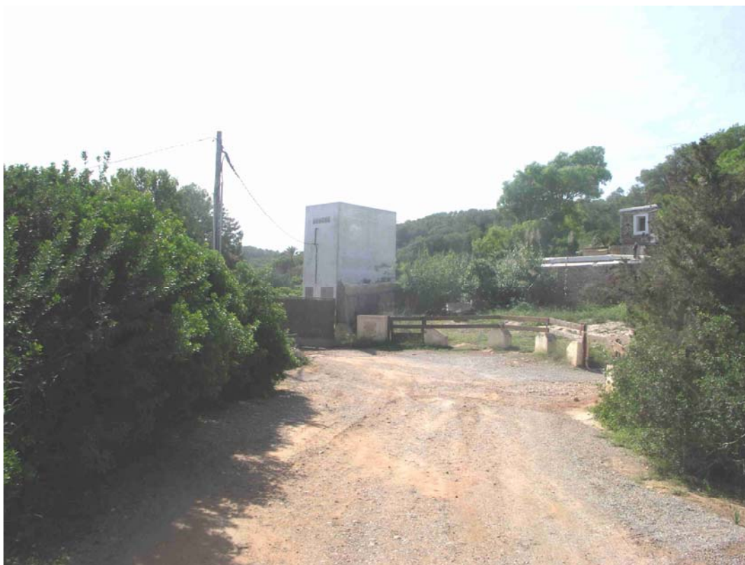
Foto 43. Centro de transformación y distribución CD Sal Rossa , que será demolido y eliminado.
