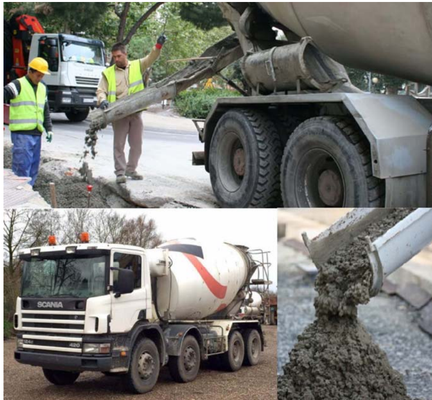
Fotos 25 a 28. Ejemplos de aplicación de hormigón sobre zanja desde camión cuba.
