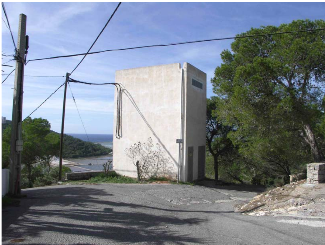
Foto 77. Centro de transformación y distribución “CD Can Mariano Mayans”. Desde este punto, parte la nueva línea de BT soterrada proyectada en esta zona urbanizada.
