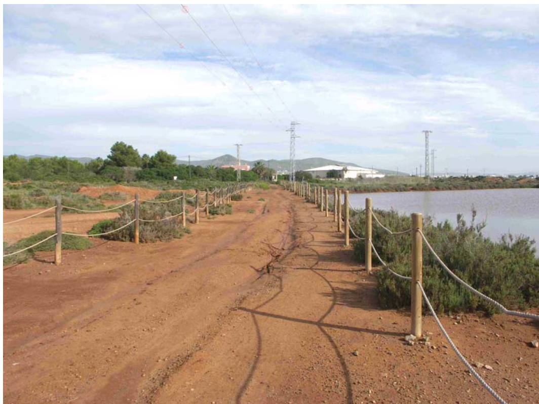
Foto 11. Continuación del camino afectado por las líneas soterradas de MT y telefonía, y por la ruta peatonal y ciclista. Tiene instalado ya un vallado de sustrorio protector de las zonas húmedas colindantes al vial.
