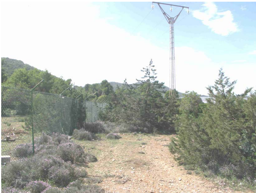
Foto 70. La nueva línea de MT llega hasta esta zona, donde el apoyo existente se sustituye por otro que permite subir la línea. Desde este punto continuará por el aire.
