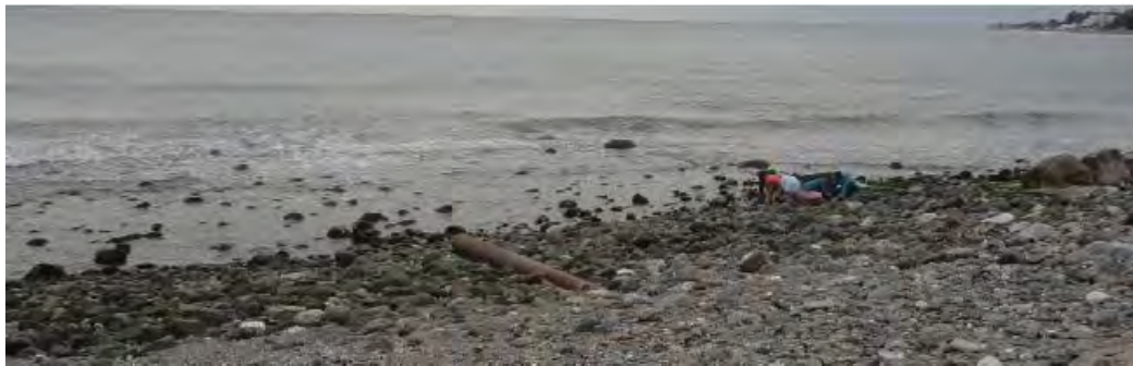
Ilustración 96. Tubería de emisario submarino en la playa de San Pedro de Alcántara
