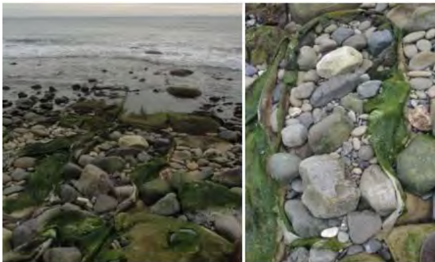
Ilustración 8. Estado de deterioro en que se encuentran los módulos que conforman el arranque del espigón NE (Documento Ambiental 2014)
