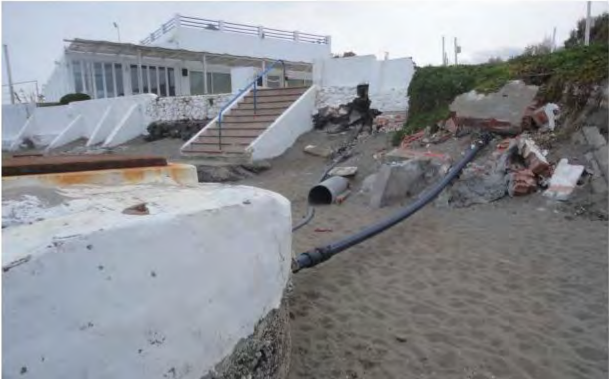
Ilustración 114. Pozo de bombeo de agua de mar y estado en que se encuentran las conducciones y el muro divisorio de la piscina de agua salada del “Beach Club” del restaurante “El Ancla”, playa de Linda Vista (Fuente: Documento Ambiental, 2014)
