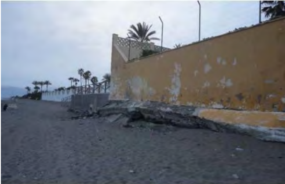
Ilustración 20. Vista frontal y estado de deterioro y socavación del muro que delimita el trasdós de la playa de Guadalmina a la altura de las termas romanas de Las Bóvedas (Documento Ambiental 2014)
