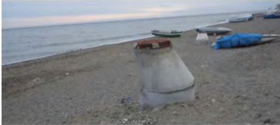
Ilustración 15. Pozo de saneamiento a la vista en la playa de Linda Vista frente al mismo (Documento Ambiental 2014)
