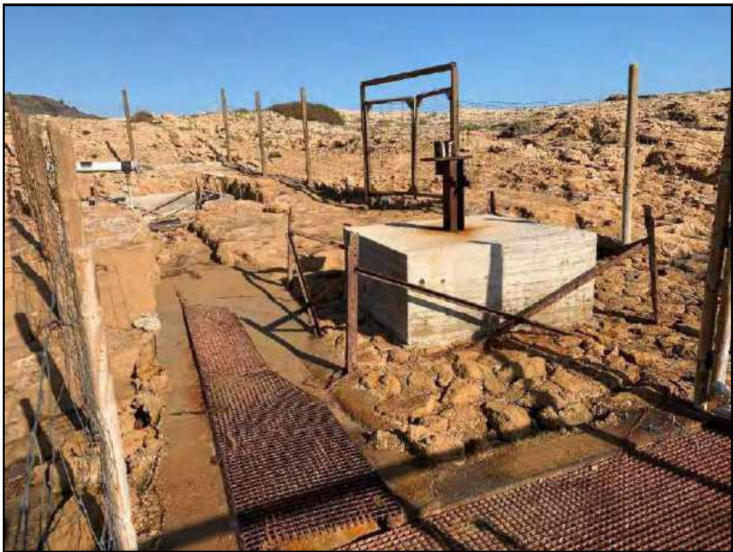
Estado actual de las instalaciones de impulsión.
