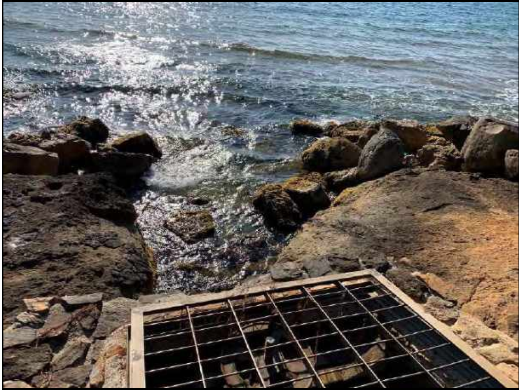
Entrada de agua desde costa con compuerta manual.
