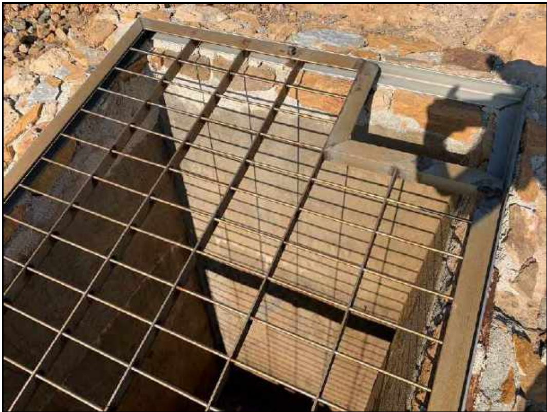
Estado de la reja de protección e interior de la arqueta.
