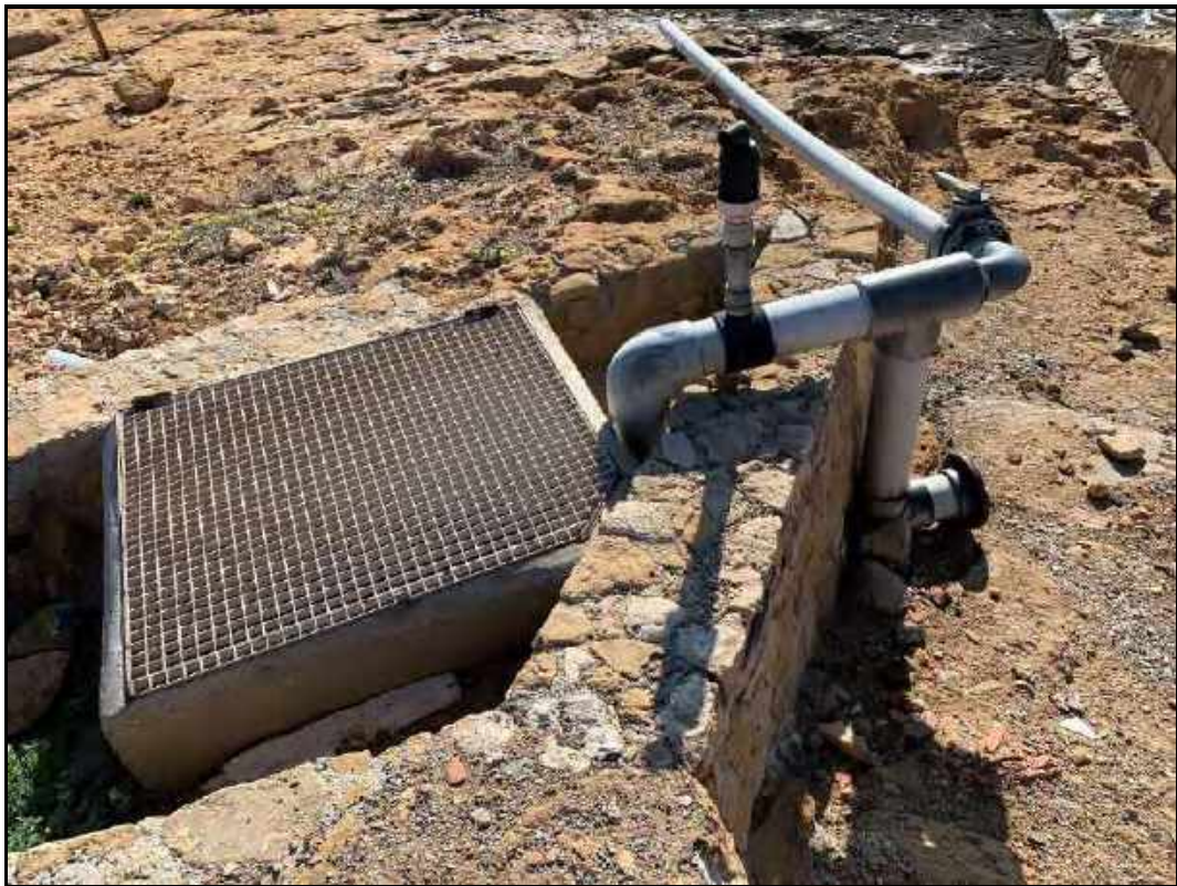
Sistema de arqueta y tuberías. Estado actual.
