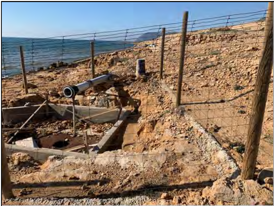
Estado actual de las instalaciones de impulsión.
