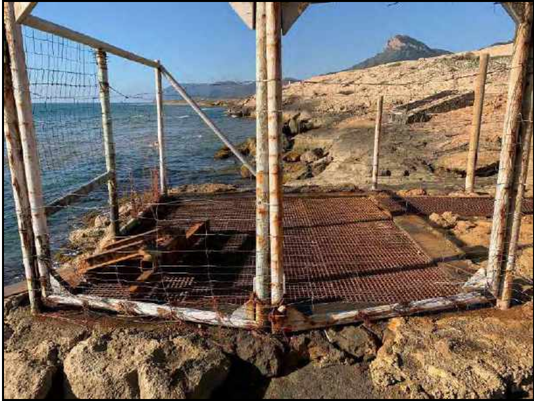
Estado actual de las instalaciones. Óxido en los elementos metálicos.
