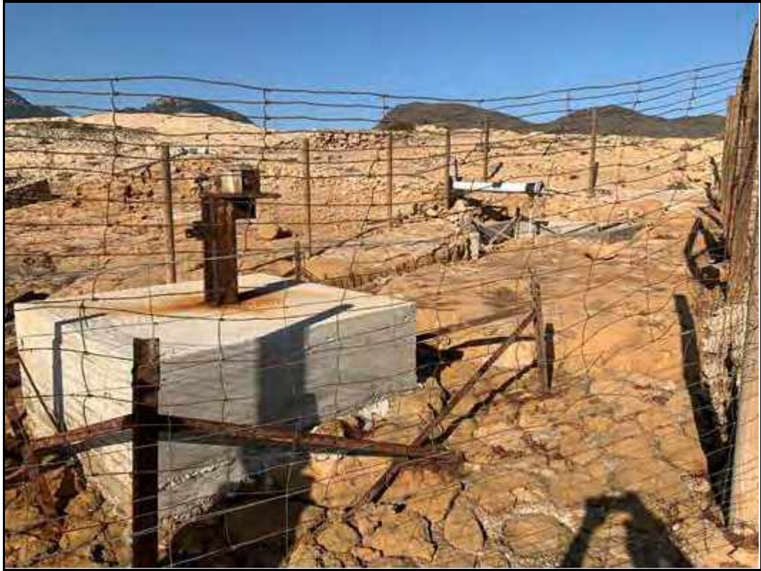
Estado actual de las instalaciones de impulsión.
