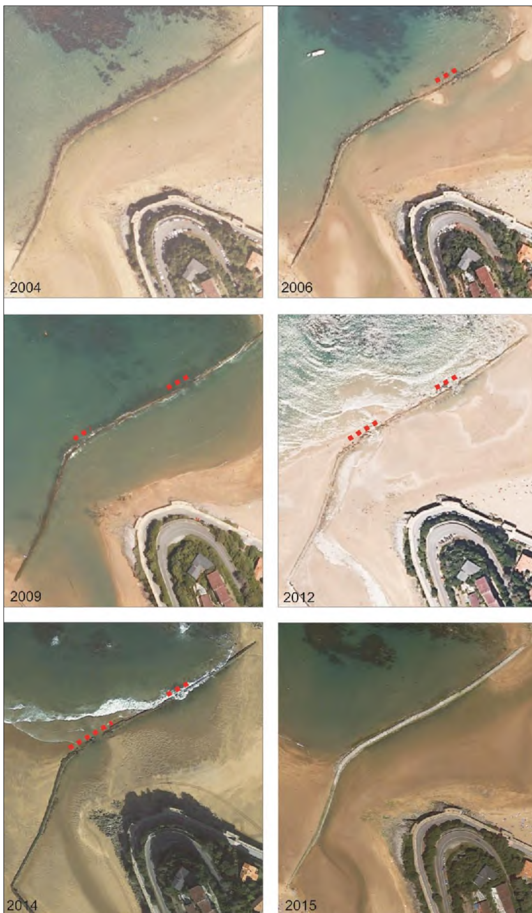
Figura 4.1 – Fotografías de la evolución de la estructura del malecón de Lazunarri desde el año 2004, con indicación del progreso de las averías
