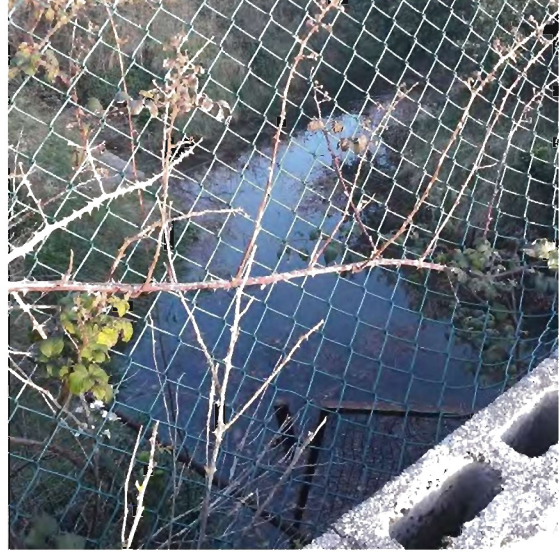
Foto 18: Marea alta aguas arriba paso carretera
