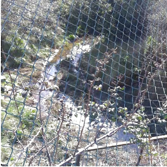
Foto 17: Marea alta aguas arriba paso carretera
