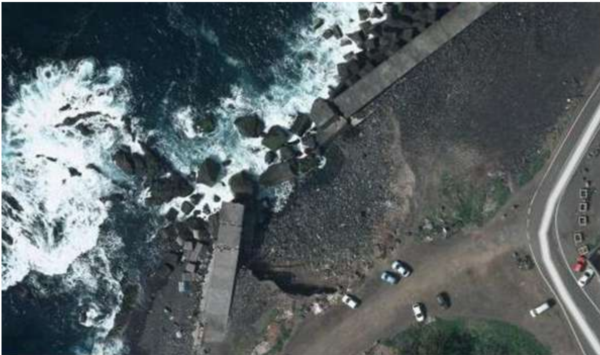
Vista aérea actual del ámbito del Parque Marítimo, tramo de defensa a reparar.
